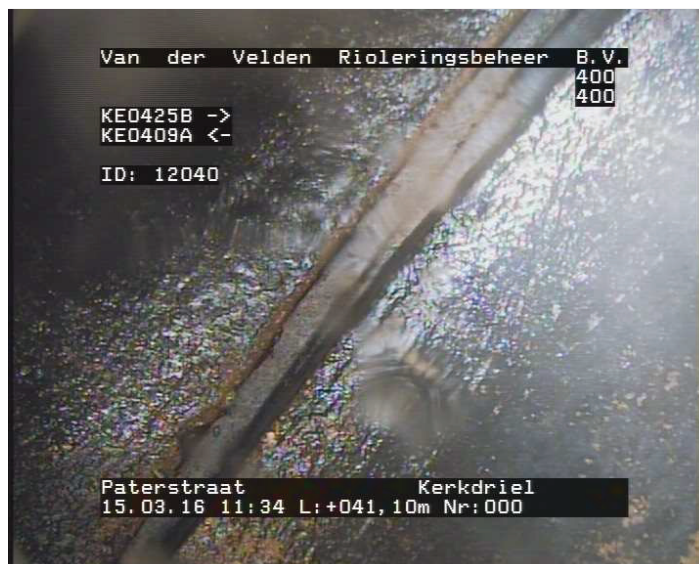
41.10 m1 Foto 031523912: Verplaatste verbinding Hoekverdraaiing
