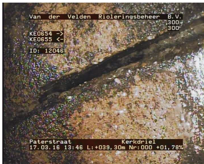
39.30 m1 Foto 031702912: Verplaatste verbinding Hoekverdraaiing
