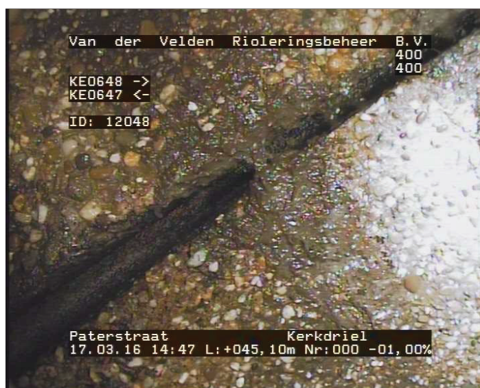
45.10 m1 Foto 031705612: Verplaatste verbinding Hoekverdraaiing
