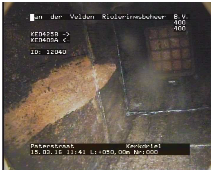
50.00 m1 Foto 031524212: Infiltratie Doorzweten
