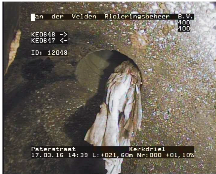
21.60 m1 Foto 031704812: Defectieve aansluiting Aansluitende buis verstopt
