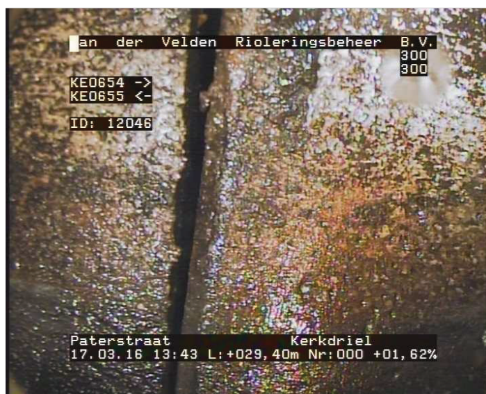
29.40 m1 Foto 031702712: Verplaatste verbinding Hoekverdraaiing
