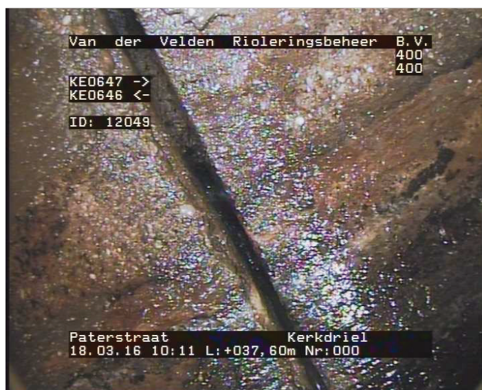
37.60 m1 Foto 031808712: Verplaatste verbinding Hoekverdraaiing
