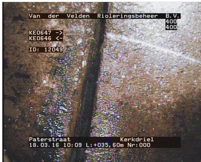
35.60 m1 Foto 031808412: Verplaatste verbinding Hoekverdraaiing
