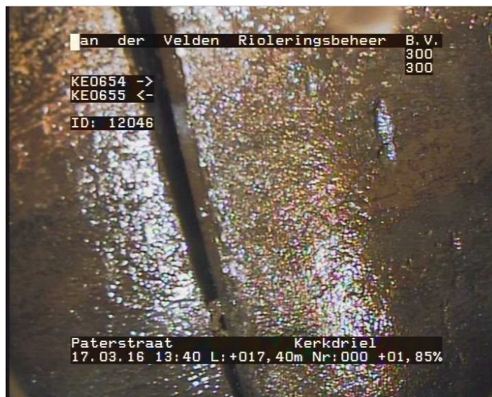
17.40 m1 Foto 031702412: Verplaatste verbinding Hoekverdraaiing
