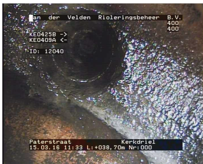
38.60 m1 Foto 031523712: Infiltratie Doorzweten
