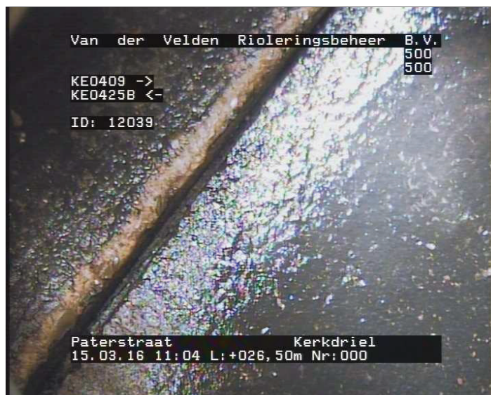
26.50 m1 Foto 031521412: Verplaatste verbinding Hoekverdraaiing
