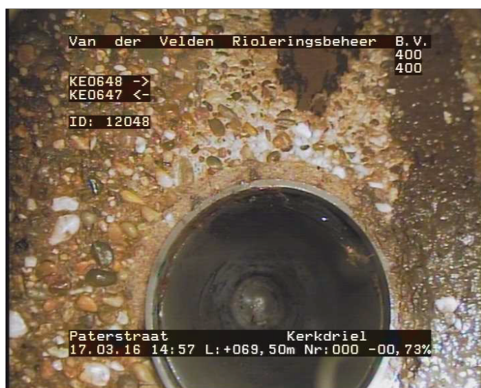
69.50 m1 Foto 031706812: Defectieve aansluiting Aansluitende buis beschadigd rubber zit niet goed
