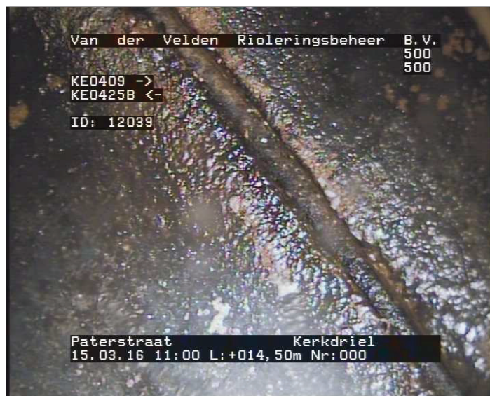
14.50 m1 Foto 031520512: Infiltratie Doorzweten
