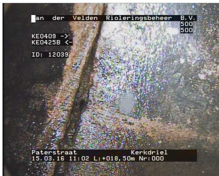
18.50 m1 Foto 031520812: Infiltratie Doorzweten
