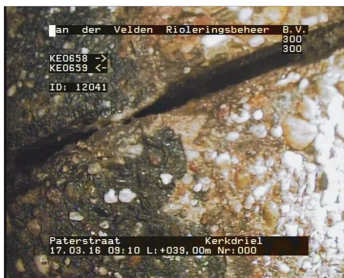
39.00 m1 Foto 031725212: Verplaatste verbinding Hoekverdraaiing
