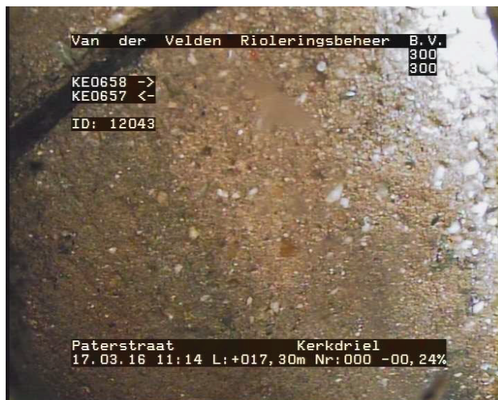
17.30 m1 Foto 031727212: Schade aan het oppervlak Afbrokkelen / zichtbare (kiezel)toeslagstof
