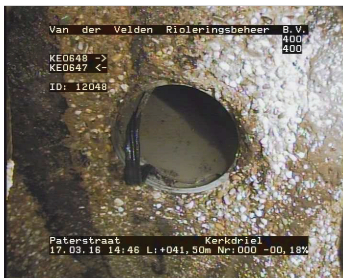
41.50 m1 Foto 031705512: Defectieve aansluiting Aansluitende buis beschadigd rubbering zit niet goed!
