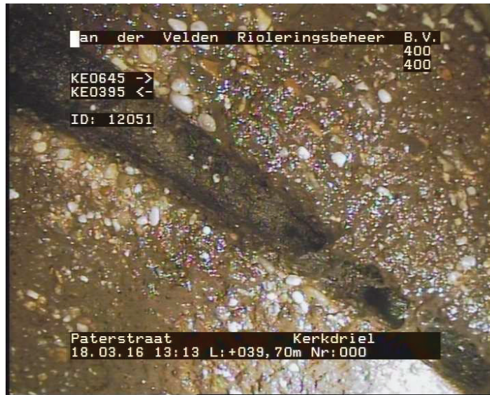
39.70 m1 Foto 031815812: Verplaatste verbinding Hoekverdraaiing
