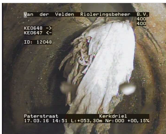
53.30 m1 Foto 031706212: Andere obstakels 10% < belemmering buisdoorsnede <= 25%
