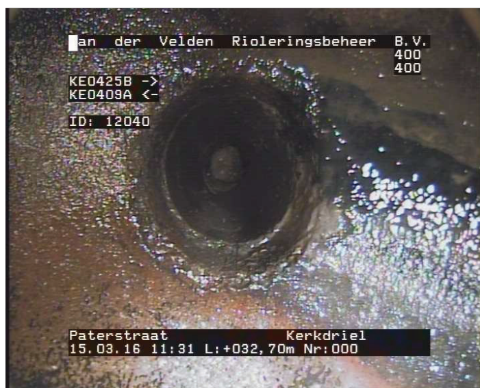
32.70 m1 Foto 031523412: Infiltratie Doorzweten
