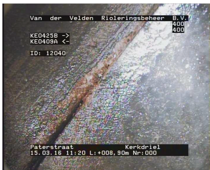
8.90 m1 Foto 031522512: Infiltratie Doorzweten
