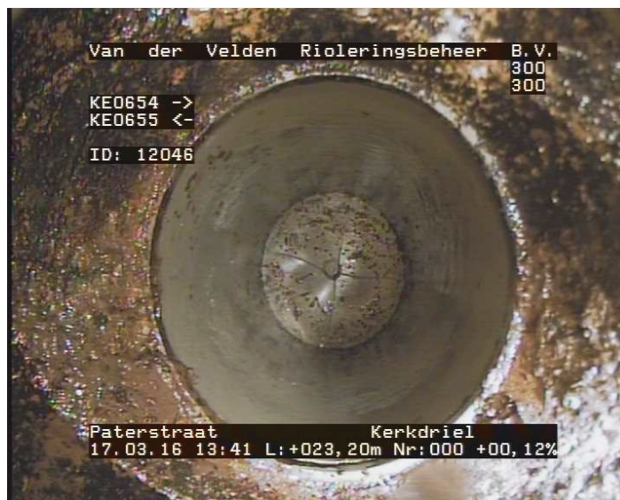
23.20 m1 Foto 031702612: Defectieve aansluiting Aansluitende buis beschadigd eindeksel gescheurd!
