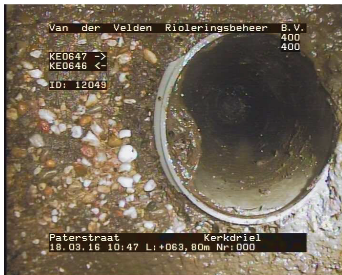
63.80 m1 Foto 031809912: Defectieve aansluiting Aansluitende buis beschadigd rubber zit niet goed!
