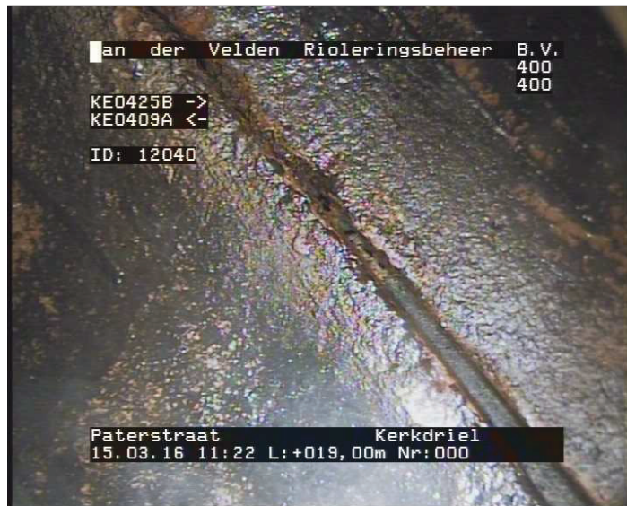
19.00 m1 Foto 031522812: Verplaatste verbinding Hoekverdraaiing
