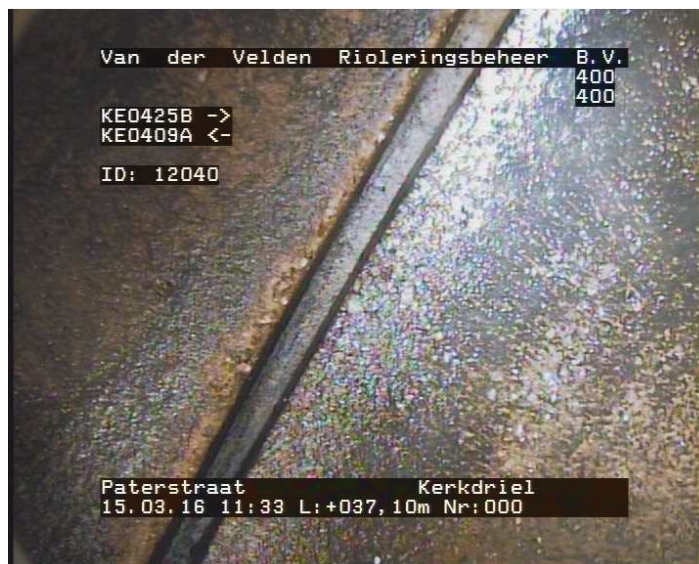
37.10 m1 Foto 031523612: Verplaatste verbinding Hoekverdraaiing
