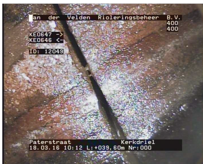
39.60 m1 Foto 031808812: Verplaatste verbinding Hoekverdraaiing
