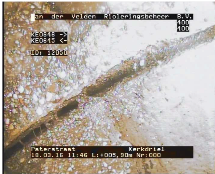
5.90 m1 Foto 031813112: Verplaatste verbinding Hoekverdraaiing
