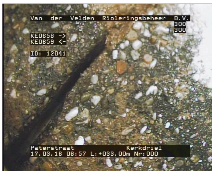
33.00 m1 Foto 031725112: Verplaatste verbinding Hoekverdraaiing
