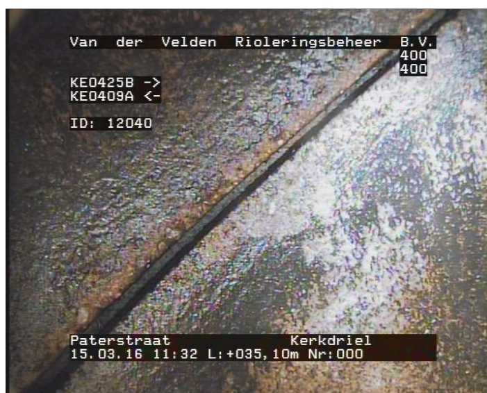
35.10 m1 Foto 031523512: Verplaatste verbinding Hoekverdraaiing
