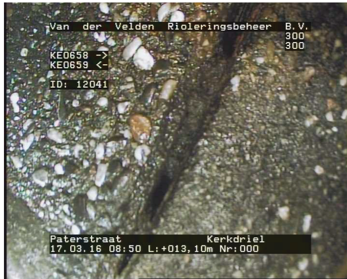
13.10 m1 Foto 031724712: Verplaatste verbinding Hoekverdraaiing
