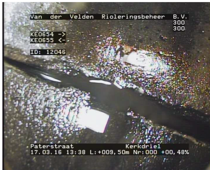
9.50 m1 Foto 031702312: Verplaatste verbinding Hoekverdraaiing
