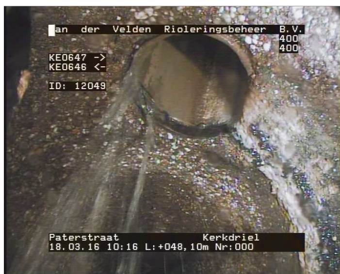
48.10 m1 Foto 031809212: Defectieve aansluiting Aansluitende buis beschadigd rubber zit niet goed!
