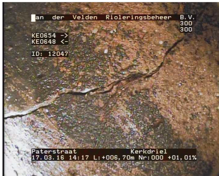
6.70 m1 Foto 031703912: Wortels Belemmering buisdoorsnede <= 10%
