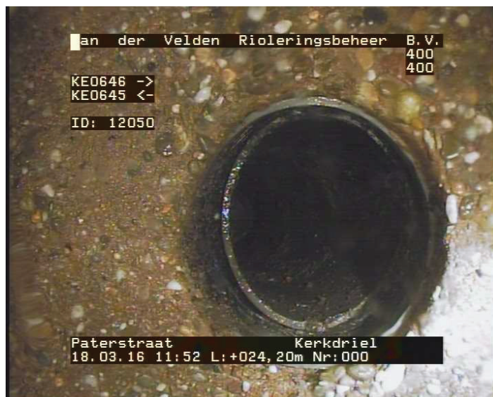
24.20 m1 Foto 031813512: Defectieve aansluiting Plaats van de aansluiting niet juist Standpijp schuin ingestoken!
