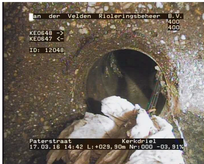
29.90 m1 Foto 031705112: Defectieve aansluiting Aansluitende buis beschadigd rubber zit niet goed!
