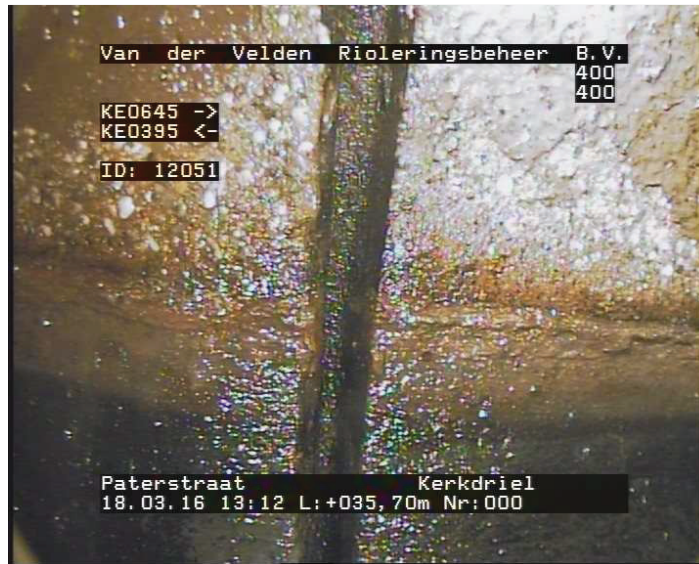
35.70 m1 Foto 031815512: Verplaatste verbinding Hoekverdraaiing
