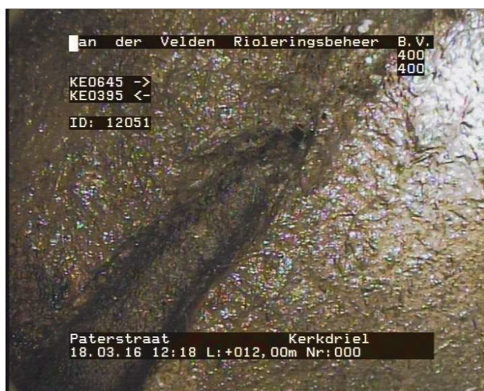
12.00 m1 Foto 031814812: Verplaatste verbinding Hoekverdraaiing
