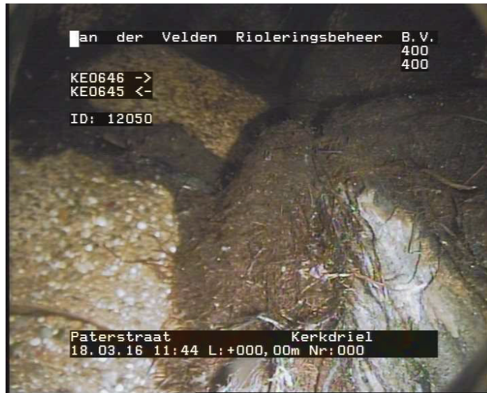
0.00 m1 Foto 031812812: Wortels Belemmering buisdoorsnede <= 10%
