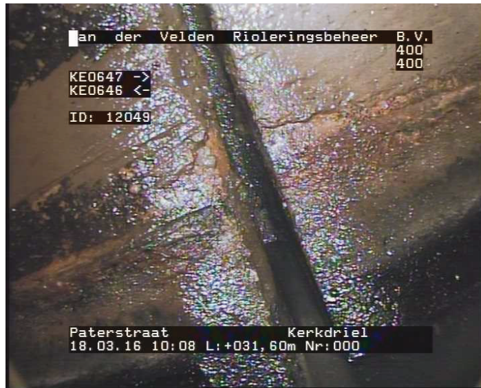
31.60 m1 Foto 031808312: Verplaatste verbinding Hoekverdraaiing
