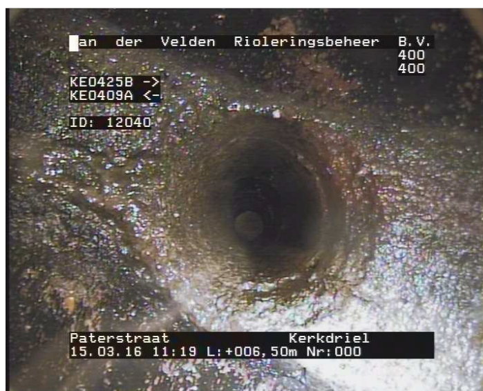
6.50 m1 Foto 031522212: Infiltratie Doorzweten
