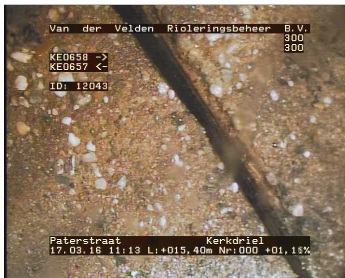
15.40 m1 Foto 031727112: Verplaatste verbinding Hoekverdraaiing
