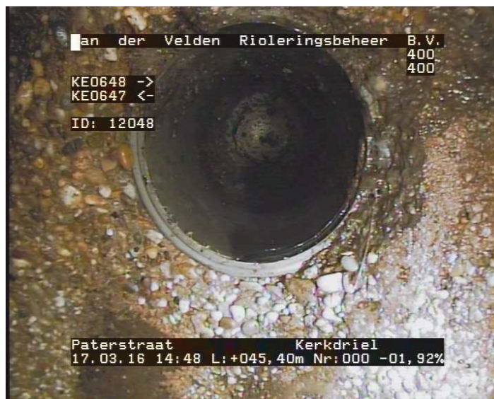
45.40 m1 Foto 031705712: Defectieve aansluiting Aansluitende buis beschadigd rubber zit niet goed!
