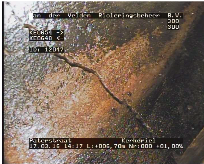
6.70 m1 Foto 031703812: Scheur Scheur - open scheuren in de buiswand
