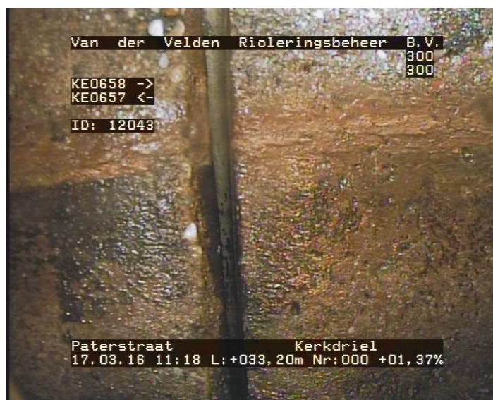
33.20 m1 Foto 031727612: Verplaatste verbinding Hoekverdraaiing
