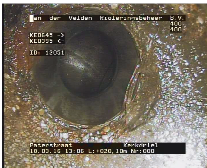
20.10 m1 Foto 031815012: Defectieve aansluiting Aansluitende buis beschadigd rubber zit niet goed!
