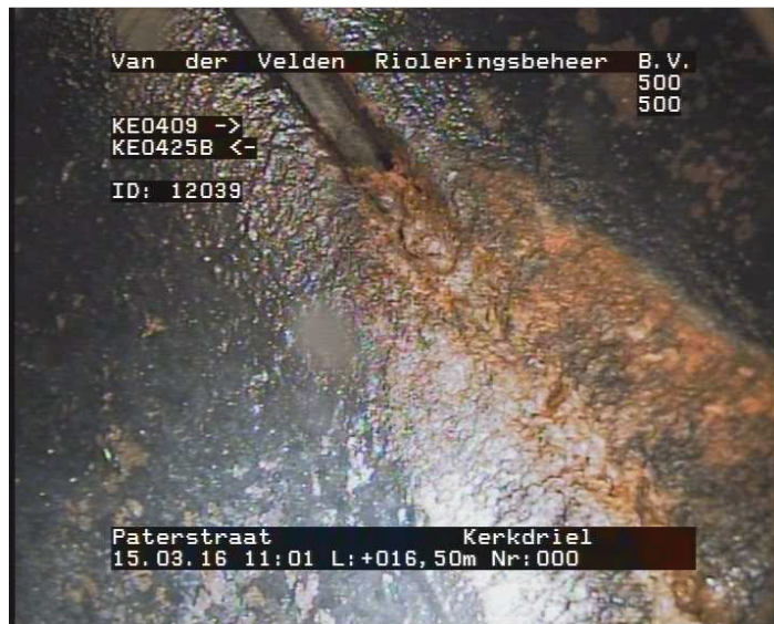
16.50 m1 Foto 031520712: Infiltratie Doorzweten
