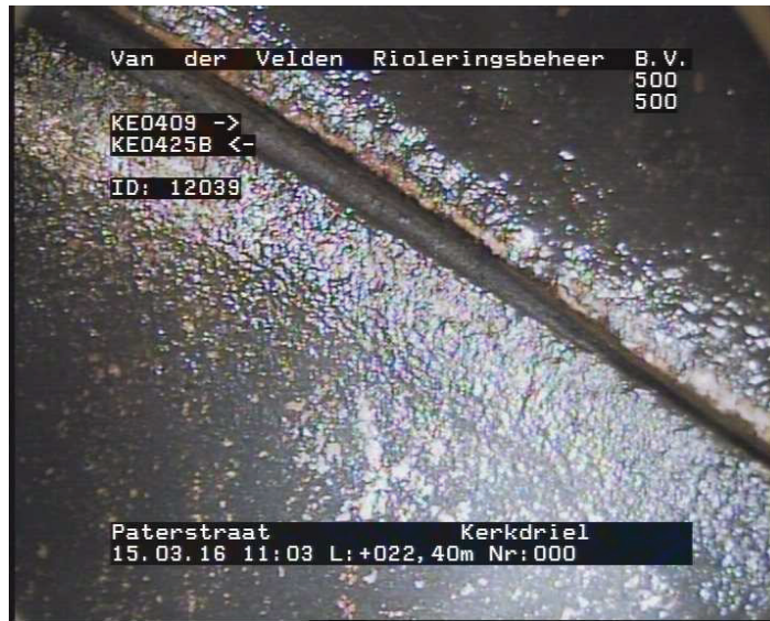
22.40 m1 Foto 031521212: Verplaatste verbinding Hoekverdraaiing
