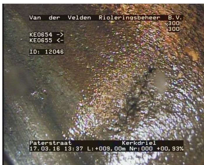
9.00 m1 Foto 031702212: Schade aan het oppervlak Afbrokkelen / zichtbare (kiezel)toeslagstof
