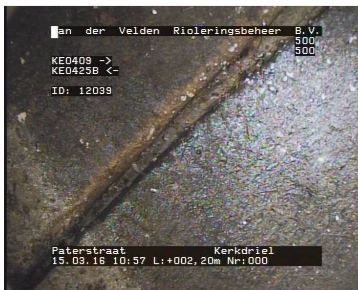
2.20 m1 Foto 031519812: Verplaatste verbinding Hoekverdraaiing
