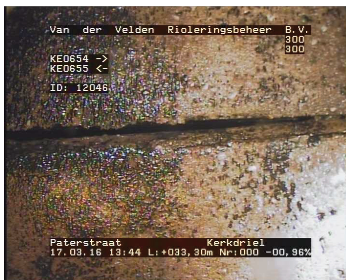
33.30 m1 Foto 031702812: Verplaatste verbinding Hoekverdraaiing
