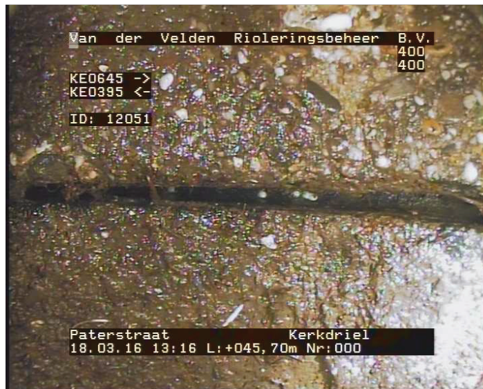
45.70 m1 Foto 031816212: Verplaatste verbinding Hoekverdraaiing
