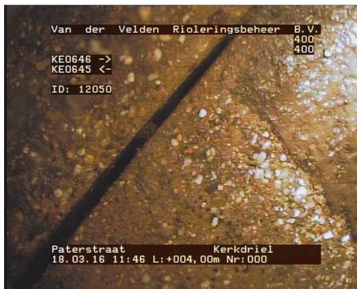
4.00 m1 Foto 031813012: Verplaatste verbinding Hoekverdraaiing
