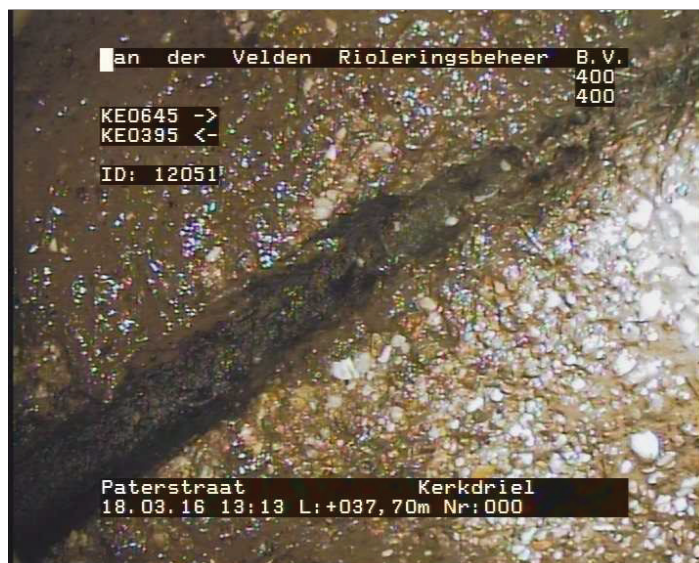
37.70 m1 Foto 031815712: Verplaatste verbinding Hoekverdraaiing
