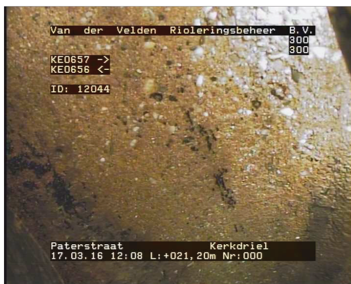
21.20 m1 Foto 031700412: Schade aan het oppervlak Afbrokkelen / zichtbare (kiesel)toeslagstof
