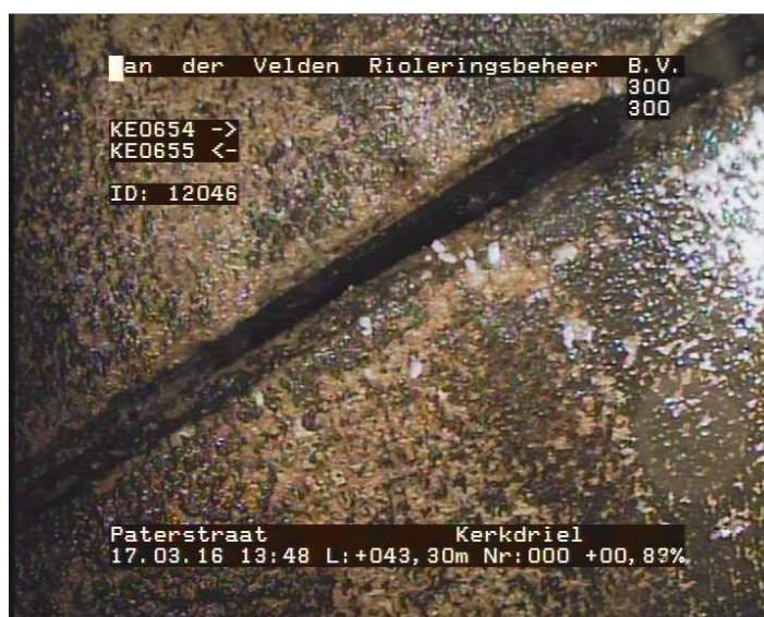
43.30 m1 Foto 031703112: Verplaatste verbinding Hoekverdraaiing
