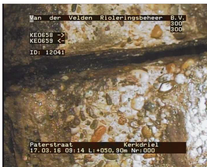
50.90 m1 Foto 031725512: Verplaatste verbinding Hoekverdraaiing
