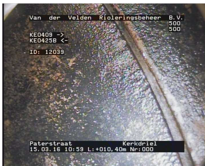
10.40 m1 Foto 031520112: Verplaatste verbinding Hoekverdraaiing
