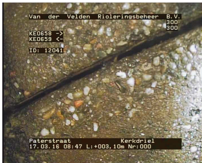
3.10 m1 Foto 031724512: Verplaatste verbinding Hoekverdraaiing
