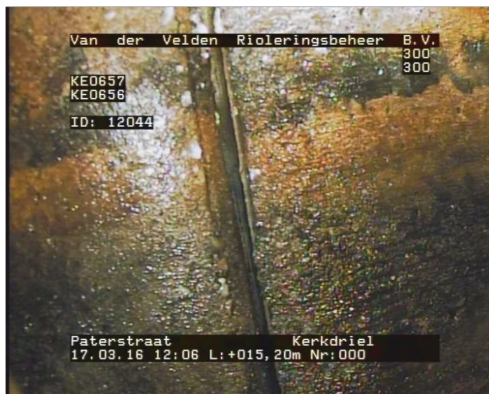
15.20 m1 Foto 031700112: Verplaatste verbinding Hoekverdraaiing
