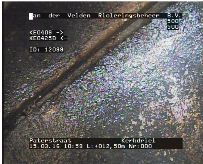
12.50 m1 Foto 031520312: Verplaatste verbinding Hoekverdraaiing
