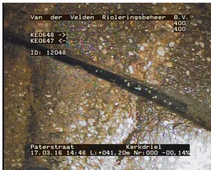
41.20 m1 Foto 031705412: Verplaatste verbinding Hoekverdraaiing
