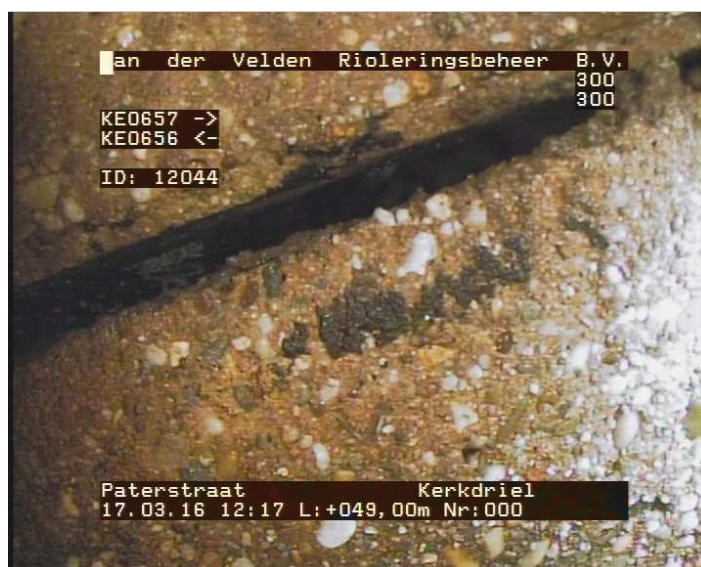
49.00 m1 Foto 031700912: Verplaatste verbinding Hoekverdraaiing
