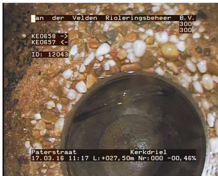
27.50 m1 Foto 031727512: Defectieve aansluiting Aansluitende buis beschadigd rubber zit NIET goed!
