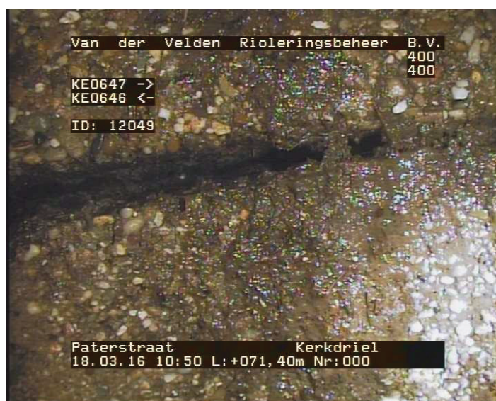
71.40 m1 Foto 031810112: Verplaatste verbinding Hoekverdraaiing
