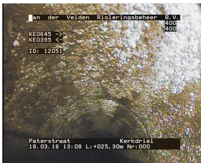
25.30 m1 Foto 031815312: Schade aan het oppervlak Toeslagstof steekt uit / wapening zichtbaar
