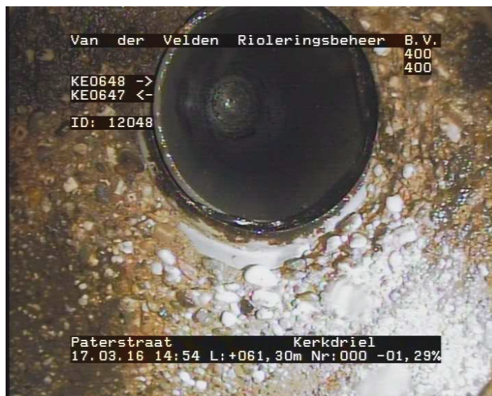
61.30 m1 Foto 031706612: Infiltratie Doorzweten
