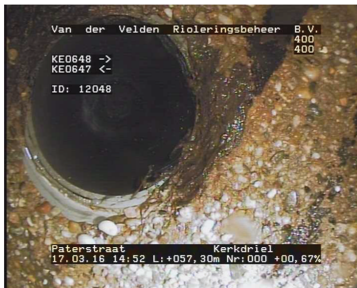
57.30 m1 Foto 031706312: Defectieve aansluiting Aansluitende buis beschadigd rubber zit niet goed!
