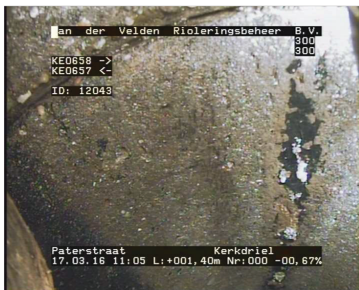
1.40 m1 Foto 031726712: Schade aan het oppervlak Afbrokkelen / zichtbare (kiezel)toeslagstof
