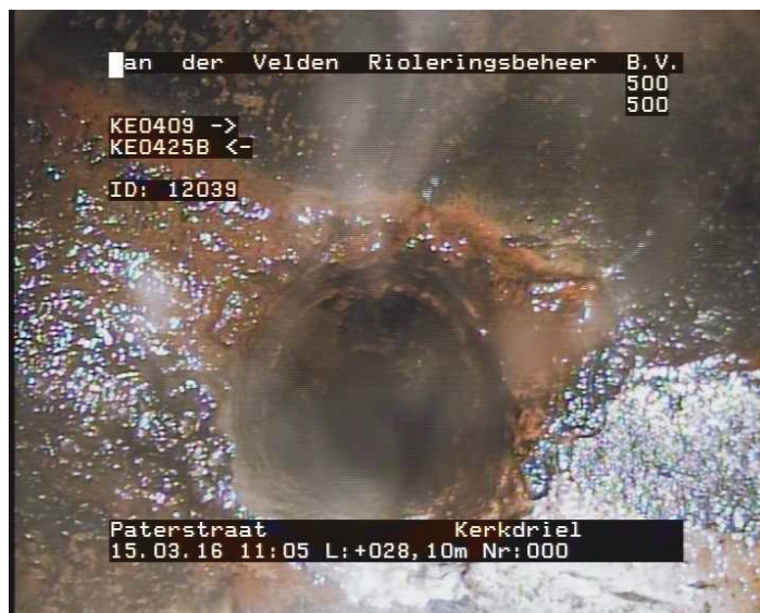
28.10 m1 Foto 031521512: Infiltratie Doorzweten
