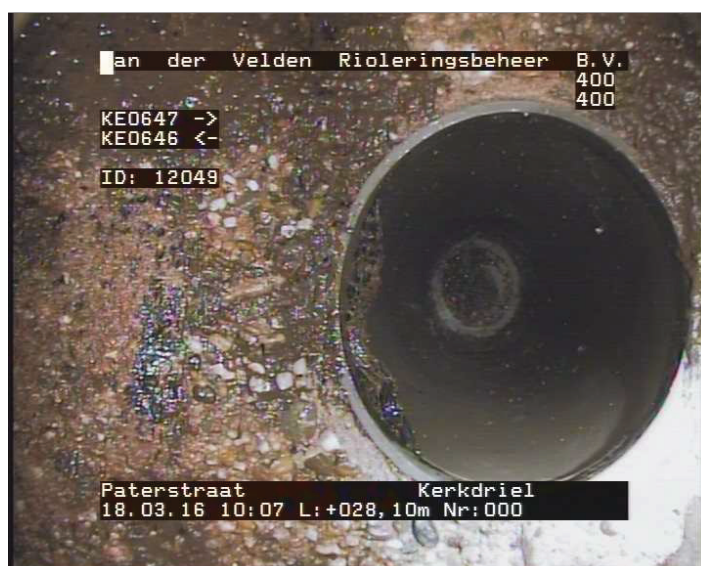
28.10 m1 Foto 031808212: Defectieve aansluiting Aansluitende buis beschadigd rubber zit niet goed!
