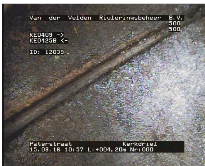
4.20 m1 Foto 031519912: Verplaatste verbinding Hoekverdraaiing
