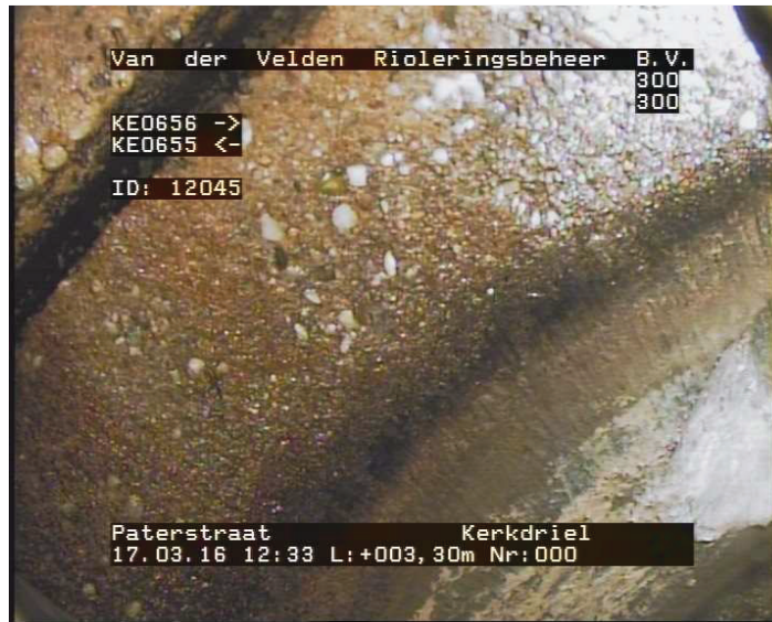
3.30 m1 Foto 031701712: Schade aan het oppervlak Afbrokkelen / zichtbare (kiezel)toeslagstof
