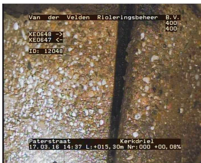
15.30 m1 Foto 031704712: Verplaatste verbinding Hoekverdraaiing
