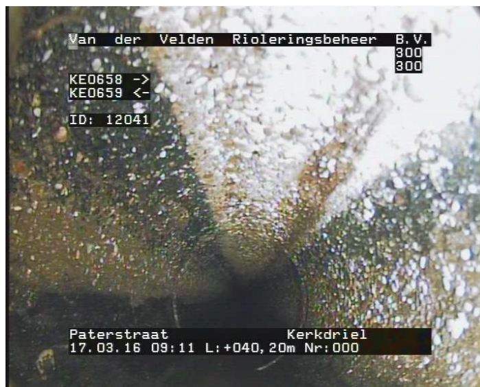
40.20 m1 Foto 031725312: Schade aan het oppervlak Toeslagstof steekt uit / wapening zichtbaar
