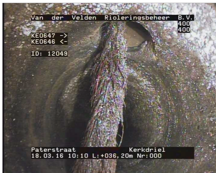
36.20 m1 Foto 031808512: Wortels 10% < belemmering buisdoorsnede <= 25%
