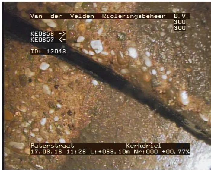
63.10 m1 Foto 031728412: Verplaatste verbinding Hoekverdraaiing
