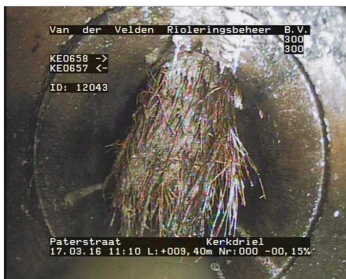
9.40 m1 Foto 031726812: Wortels Belemmering buisdoorsnede > 50%
