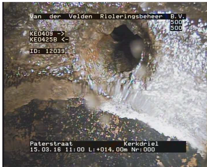
14.00 m1 Foto 031520412: Infiltratie Doorzweten
