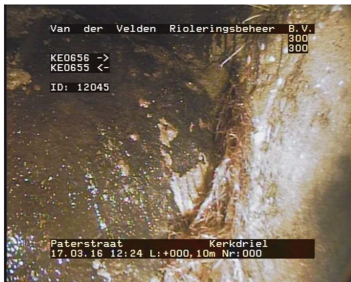
0.10 m1 Foto 031701412: Wortels Belemmering buisdoorsnede <= 10%
