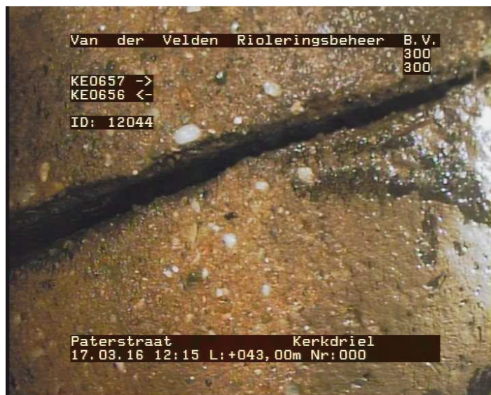
43.00 m1 Foto 031700812: Verplaatste verbinding Hoekverdraaiing
