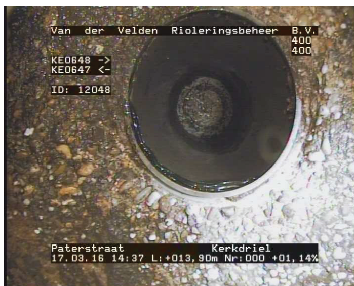
13.90 m1 Foto 031704612: Defectieve aansluiting Aansluitende buis beschadigd rubber zit niet goed!
