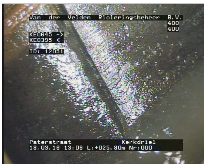
25.80 m1 Foto 031815412: Verplaatste verbinding Hoekverdraaiing
