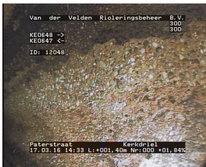
1.40 m1 Foto 031704212: Schade aan het oppervlak Toeslagstof steekt uit / wapening zichtbaar
