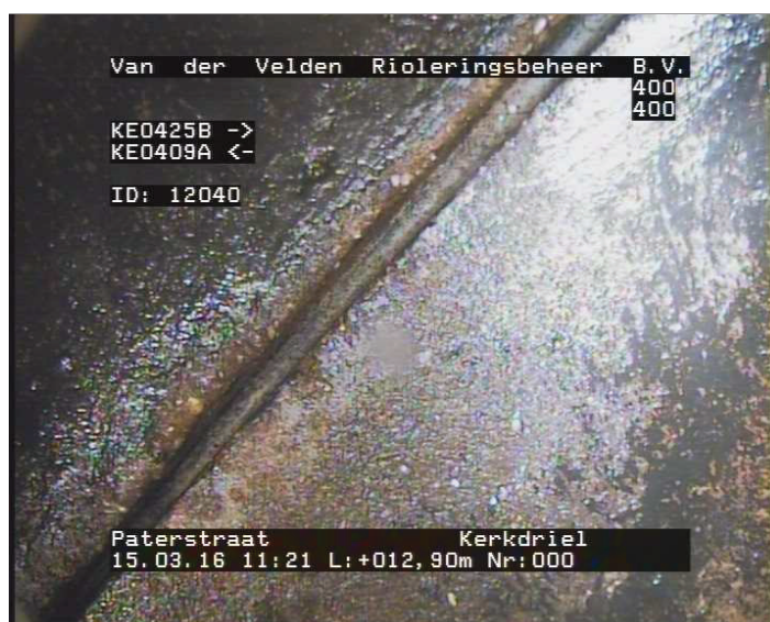
12.90 m1 Foto 031522612: Verplaatste verbinding Hoekverdraaiing
