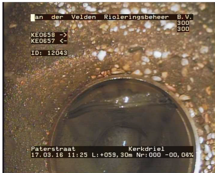
59.30 m1 Foto 031728212: Defectieve aansluiting Aansluitende buis beschadigd rubber zit niet goed!
