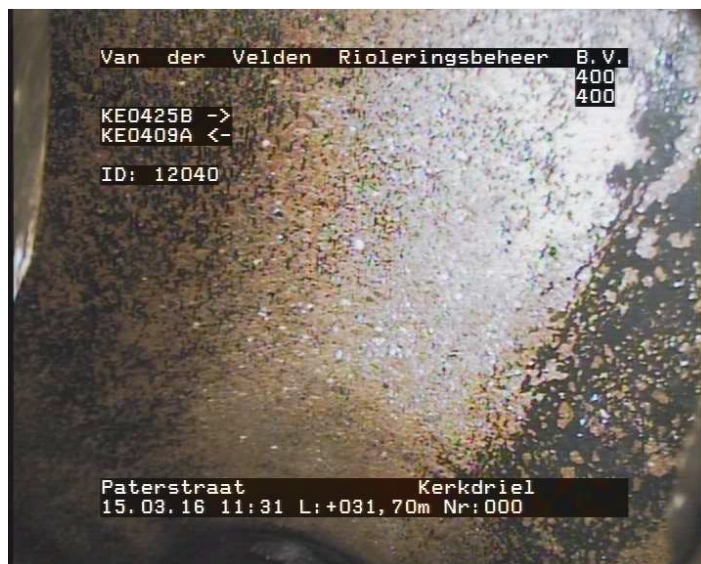
31.70 m1 Foto 031523312: Schade aan het oppervlak Afbrokkelen / zichtbare (kiezel)toeslagstof
