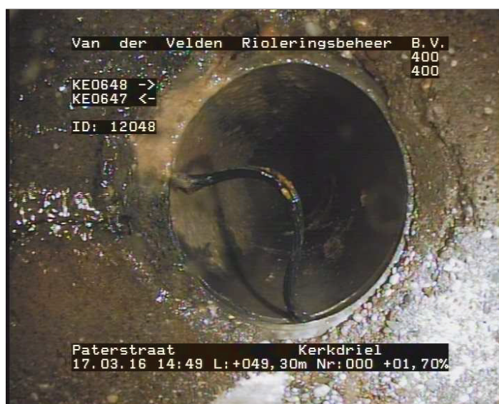
49.30 m1 Foto 031705912: Defectieve aansluiting Aansluitende buis beschadigd rubber zit niet goed!
