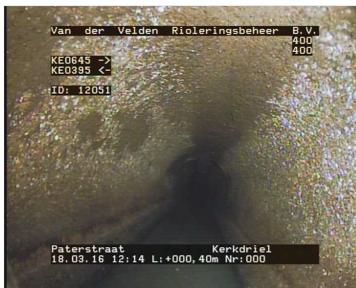
0.40 m1 Foto 031814712: Schade aan het oppervlak Toeslagstof steekt uit / wapening zichtbaar
