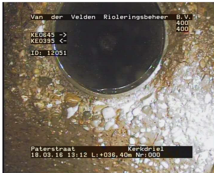
36.40 m1 Foto 031815612: Defectieve aansluiting Aansluitende buis beschadigd rubber zit niet goed
