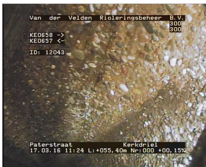
55.40 m1 Foto 031728012: Schade aan het oppervlak Toeslagstof steekt uit / wapening zichtbaar
