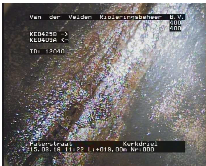
19.00 m1 Foto 031522912: Infiltratie Doorzweten
