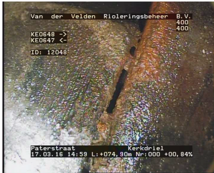
74.90 m1 Foto 031707312: Infiltratie Doorzweten
