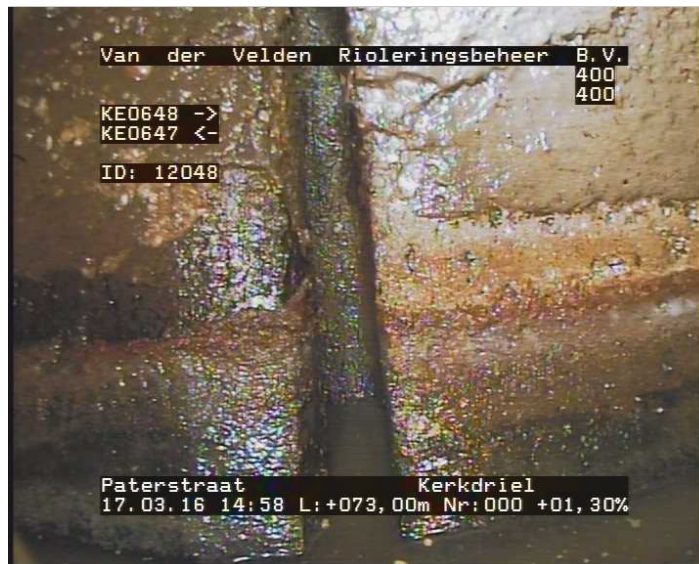
73.00 m1 Foto 031707112: Verplaatste verbinding Hoekverdraaiing
