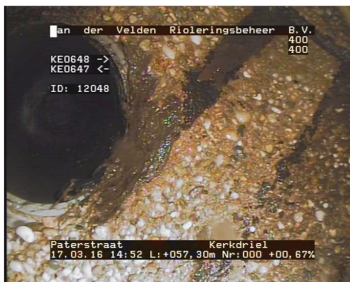
57.30 m1 Foto 031706412: Infiltratie Doorzweten
