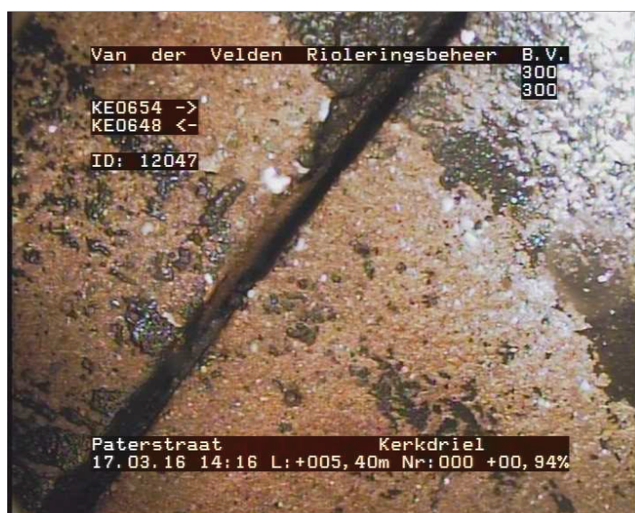
5.40 m1 Foto 031703712: Schade aan het oppervlak Afbrokkelen / zichtbare (kiesel)toeslagstof
