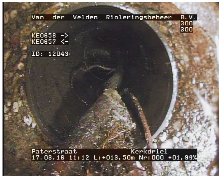
13.50 m1 Foto 031727012: Wortels Belemmering buisdoorsnede > 50%
