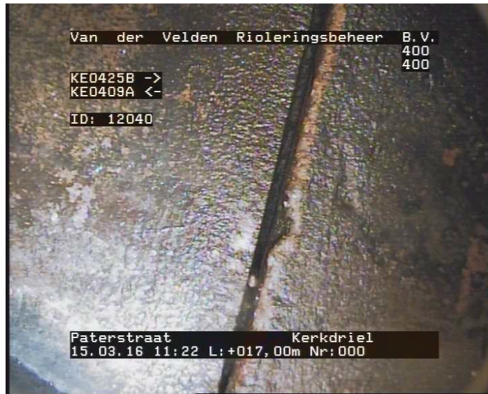
17.00 m1 Foto 031522712: Verplaatste verbinding Hoekverdraaiing
