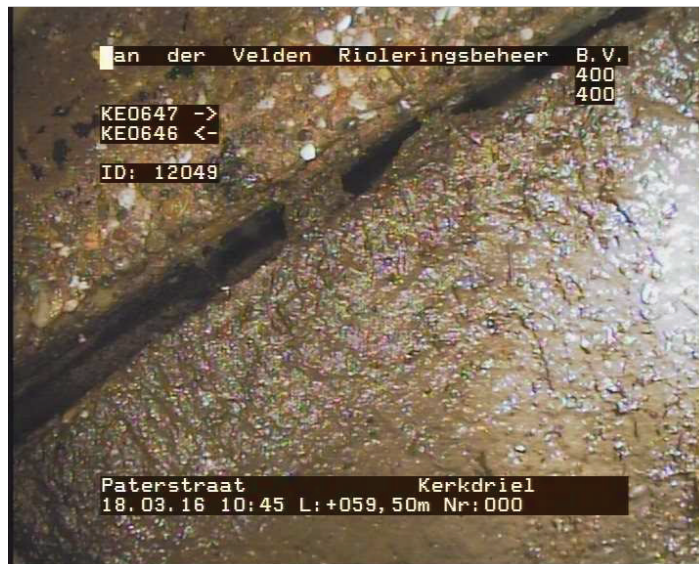
59.50 m1 Foto 031809712: Verplaatste verbinding Hoekverdraaiing
