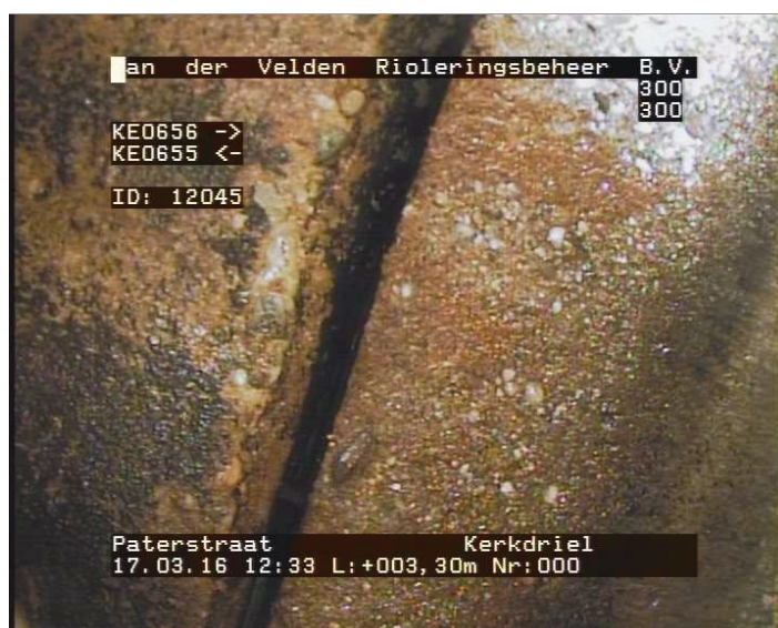
3.30 m1 Foto 031701612: Verplaatste verbinding Hoekverdraaiing
