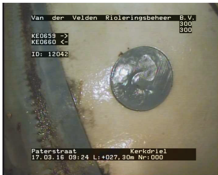
27.30 m1 Foto 031726212: Algemene opmerking Vermoedelijk een reparatie, dit is echter niet duidelijk. Eventueel nader onderzoeken!
