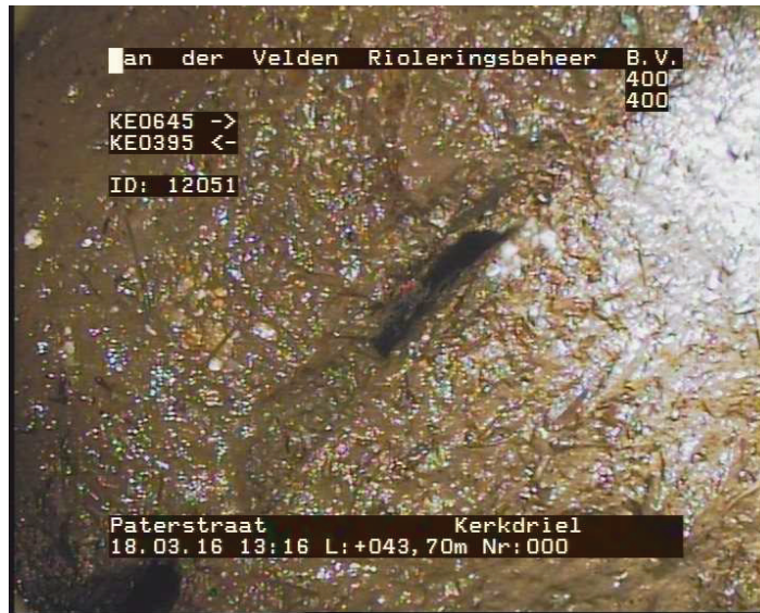
43.70 m1 Foto 031816112: Verplaatste verbinding Hoekverdraaiing
