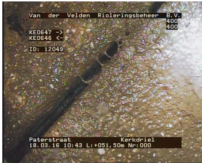
51.50 m1 Foto 031809312: Verplaatste verbinding Hoekverdraaiing
