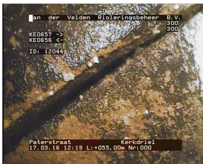
55.00 m1 Foto 031701012: Verplaatste verbinding Hoekverdraaiing
