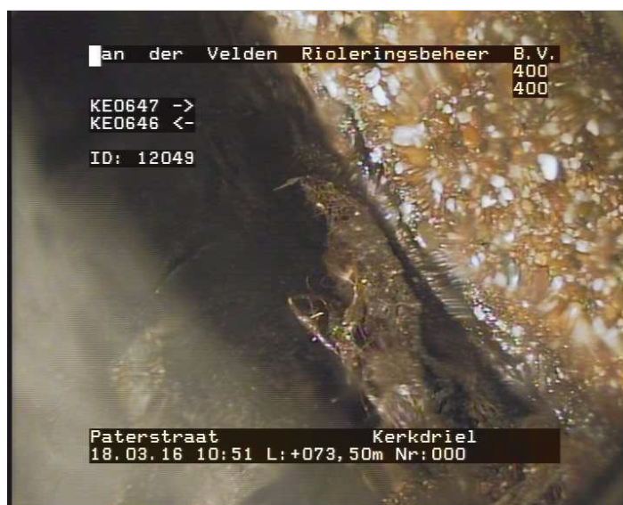
73.50 m1 Foto 031810312: Wortels Belemmering buisdoorsnede > 50%
