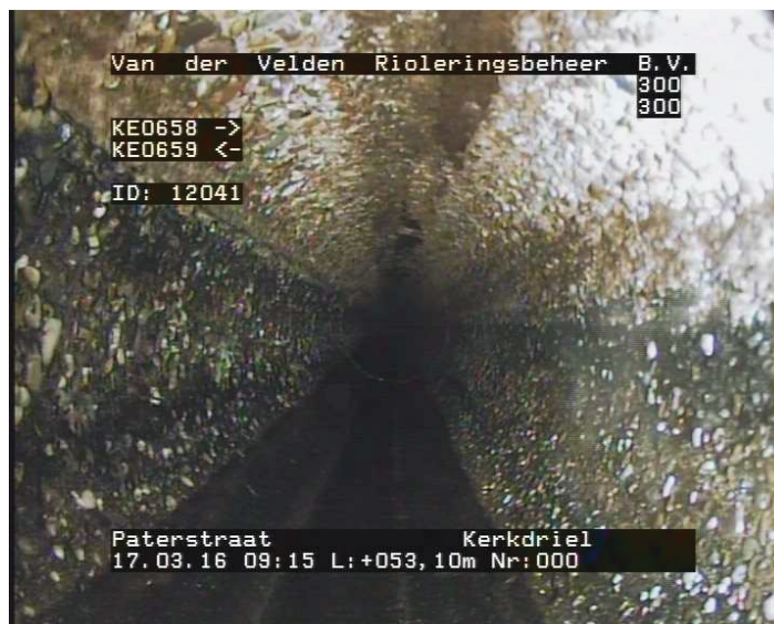
53.10 m1 Foto 031725612: Schade aan het oppervlak Toeslagstof steekt uit / wapening zichtbaar
