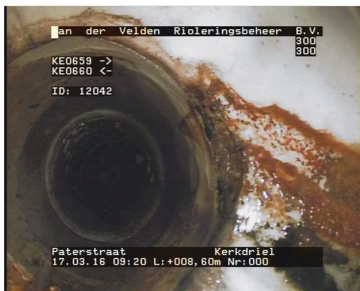
8.60 m1 Foto 031726012: Infiltratie Doorzweten
