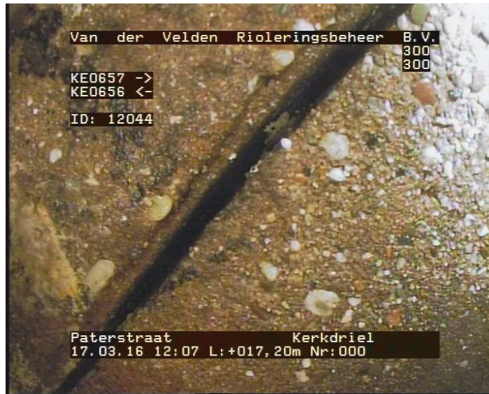
17.20 m1 Foto 031700212: Verplaatste verbinding Hoekverdraaiing
