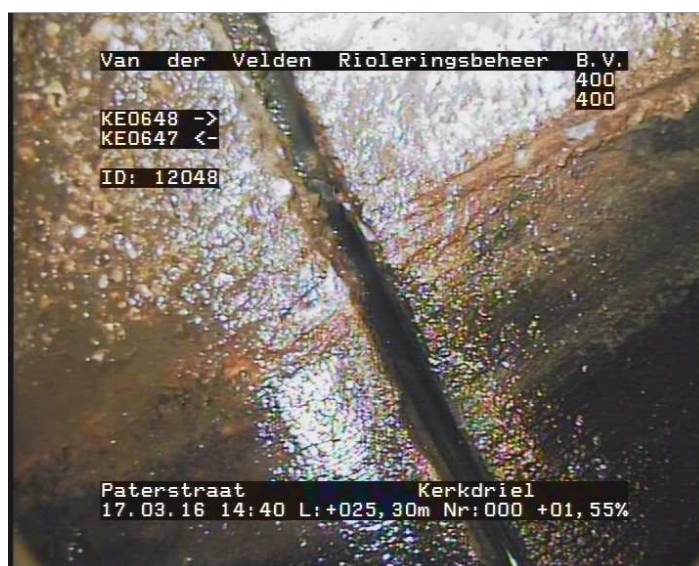
25.30 m1 Foto 031705012: Verplaatste verbinding Hoekverdraaiing
