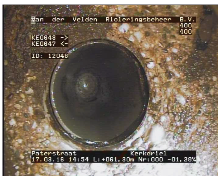
61.30 m1 Foto 031706512: Defectieve aansluiting Aansluitende buis beschadigd rubber zit niet goed
