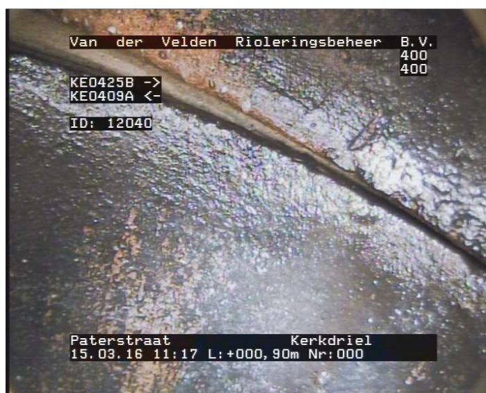
0.90 m1 Foto 031522012: Verplaatste verbinding Hoekverdraaiing
