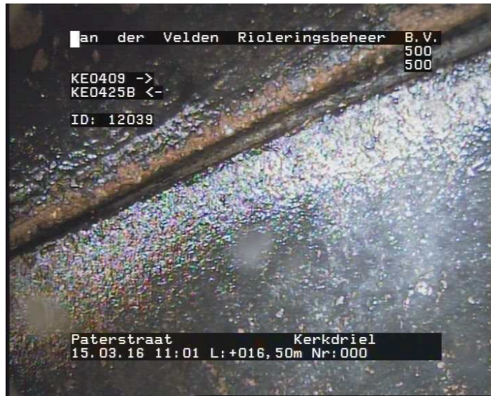
16.50 m1 Foto 031520612: Verplaatste verbinding Hoekverdraaiing
