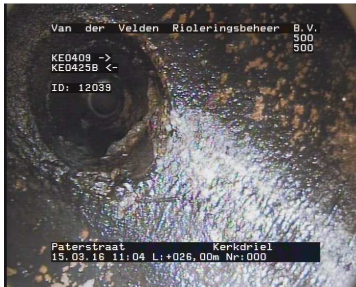
26.00 m1 Foto 031521312: Infiltratie Doorzweten
