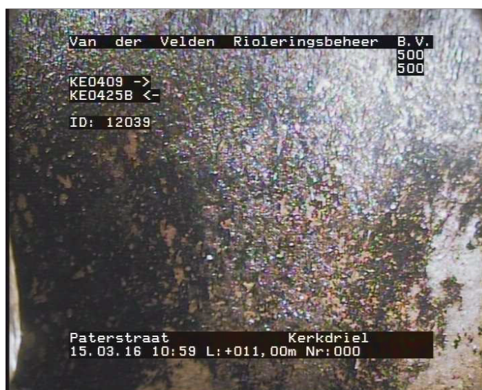
11.00 m1 Foto 031520212: Schade aan het oppervlak Afbrokkelen / zichtbare (kiesel)toeslagstof
