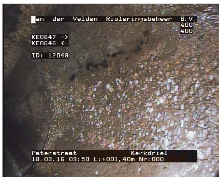
1.40 m1 Foto 031807812: Schade aan het oppervlak Toeslagstof steekt uit / wapening zichtbaar
