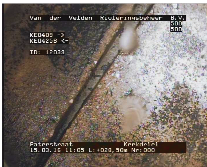
28.50 m1 Foto 031521612: Verplaatste verbinding Hoekverdraaiing
