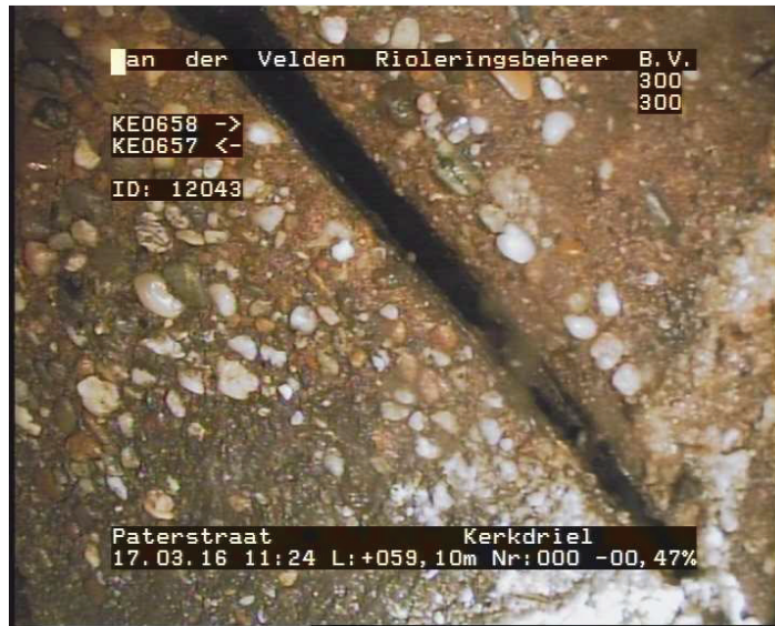
59.10 m1 Foto 031728112: Verplaatste verbinding Hoekverdraaiing
