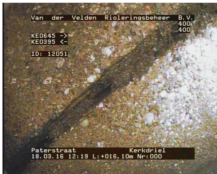
16.10 m1 Foto 031814912: Verplaatste verbinding Hoekverdraaiing
