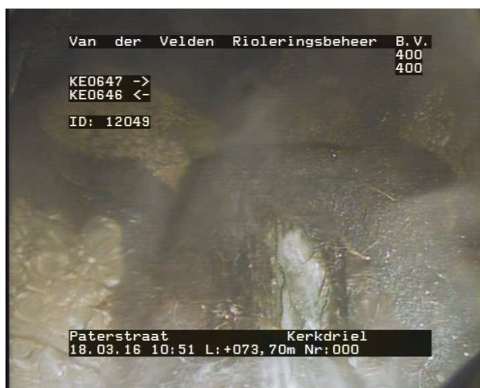
73.70 m1 Foto 031810412: Algemene opmerking aansluitende leiding in put gedeeltelijk dicht door wortels!!!
