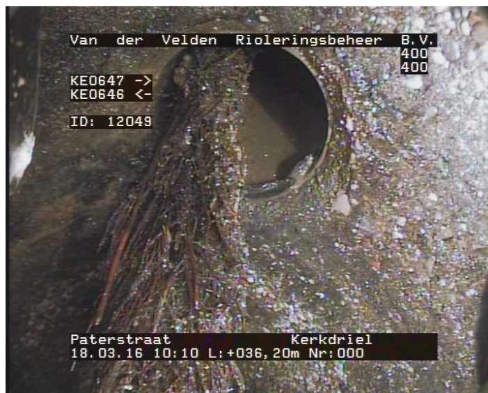
36.20 m1 Foto 031808612: Defectieve aansluiting Aansluitende buis beschadigd rubber zit niet goed!
