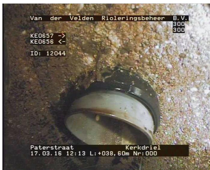
38.60 m1 Foto 031700612: Instekende aansluiting 10% < insteeklengte <= 25% van de rioolhoogte
