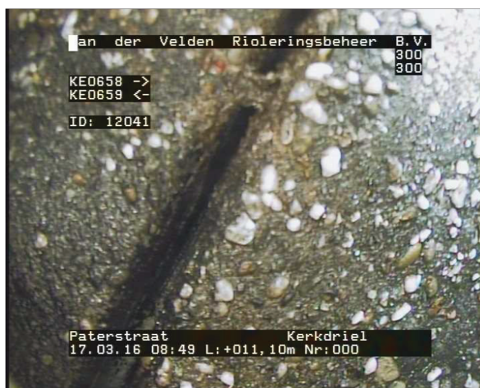
11.10 m1 Foto 031724612: Verplaatste verbinding Hoekverdraaiing
