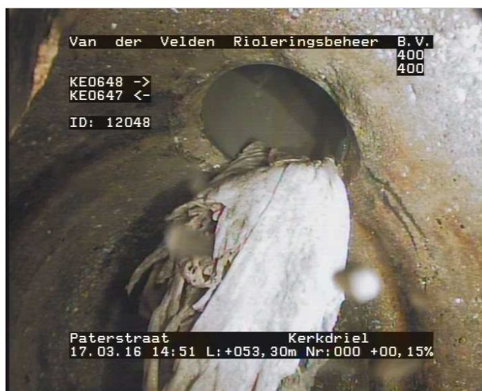
53.30 m1 Foto 031706112: Defectieve aansluiting Aansluitende buis beschadigd rubber zit niet goed!
