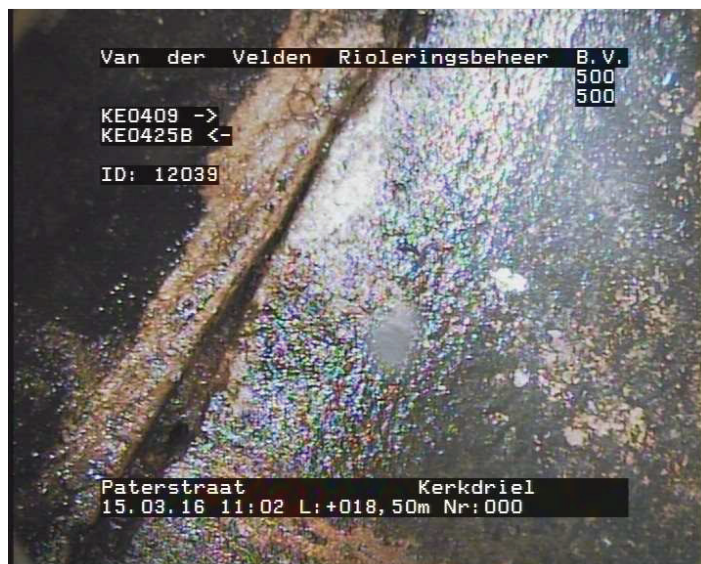
18.50 m1 Foto 031520912: Verplaatste verbinding Hoekverdraaiing
