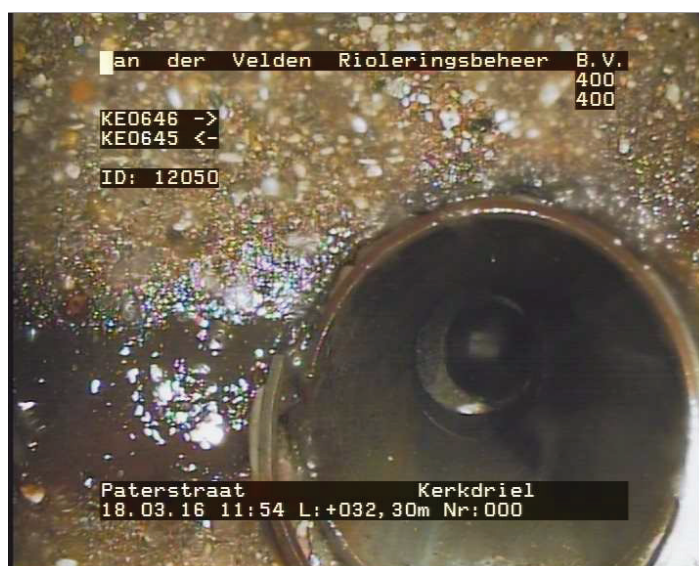
32.30 m1 Foto 031813712: Defectieve aansluiting Aansluitende buis beschadigd
