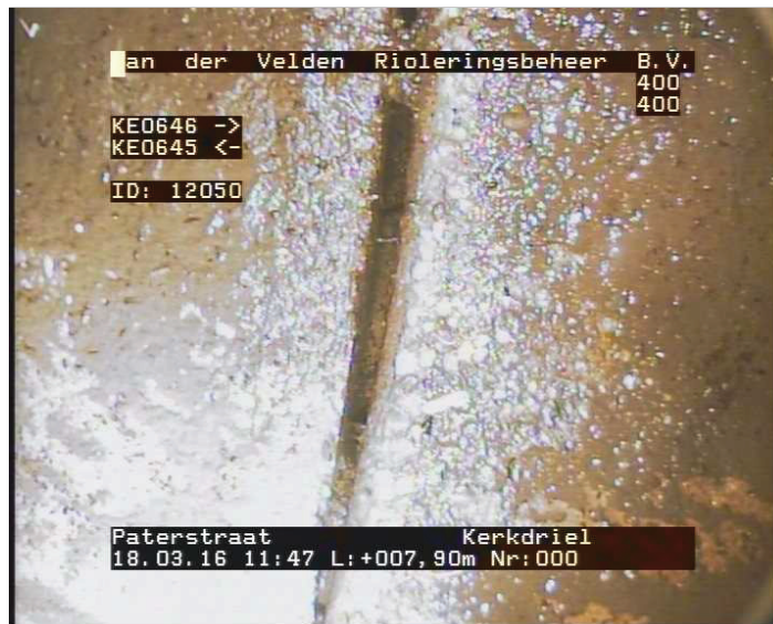
7.90 m1 Foto 031813212: Verplaatste verbinding Hoekverdraaiing
