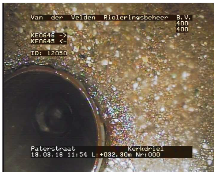
32.30 m1 Foto 031813812: Infiltratie Doorzweten
