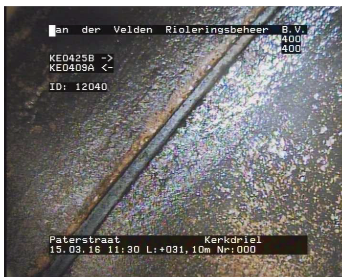
31.10 m1 Foto 031523212: Verplaatste verbinding Hoekverdraaiing
