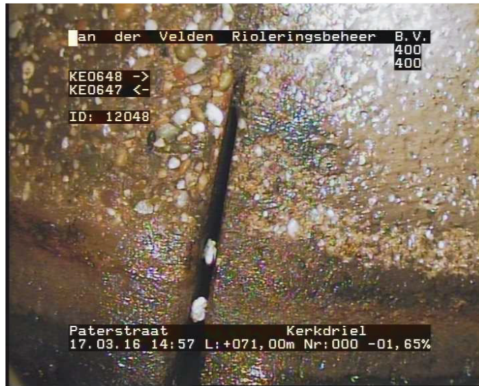
71.00 m1 Foto 031706912: Verplaatste verbinding Hoekverdraaiing
