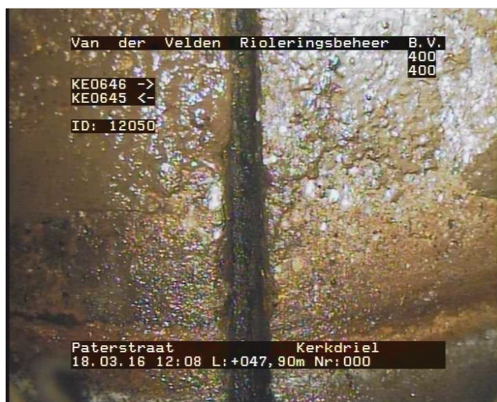
47.90 m1 Foto 031814212: Verplaatste verbinding Hoekverdraaiing
