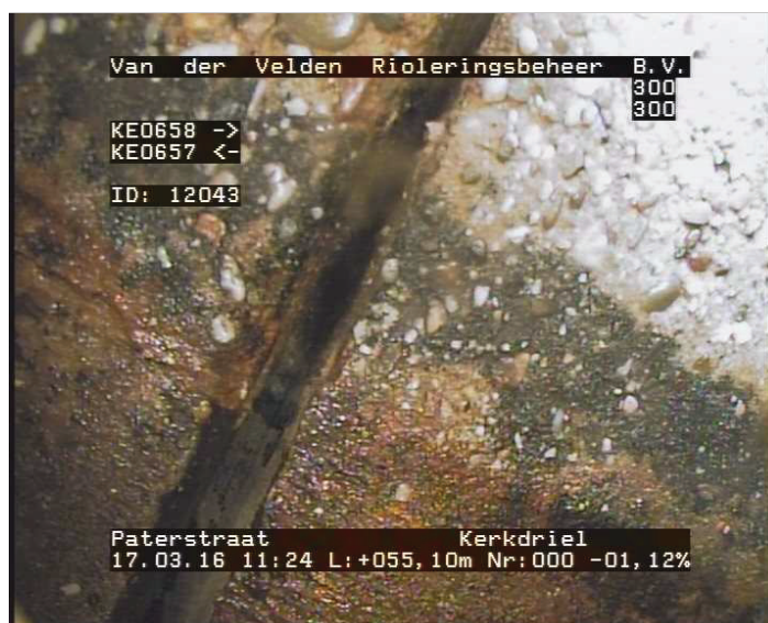
55.10 m1 Foto 031727912: Verplaatste verbinding Hoekverdraaiing
