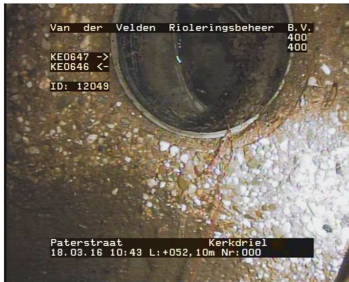
52.10 m1 Foto 031809412: Wortels Belemmering buisdoorsnede <= 10%
