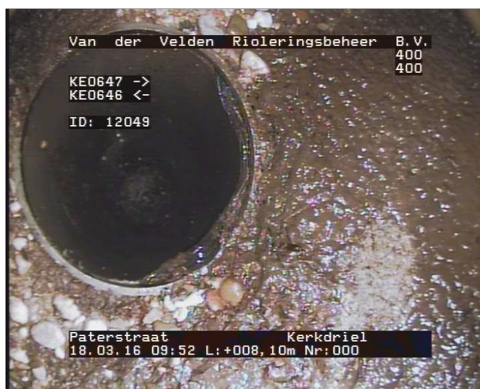
8.10 m1 Foto 031807912: Defectieve aansluiting Aansluitende buis beschadigd rubber zit niet goed!
