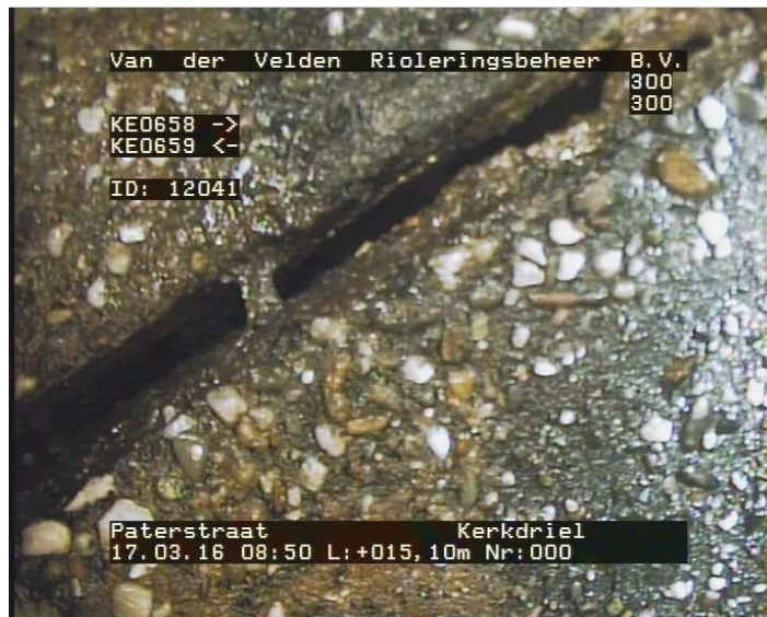
15.10 m1 Foto 031724812: Verplaatste verbinding Hoekverdraaiing
