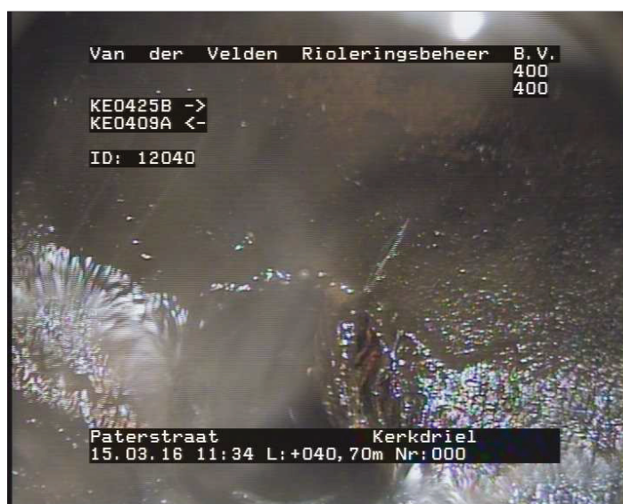
40.70 m1 Foto 031523812: Infiltratie Doorzweten
