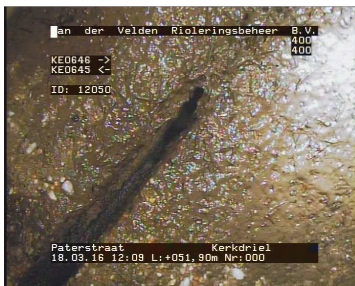
51.90 m1 Foto 031814312: Verplaatste verbinding Hoekverdraaiing
