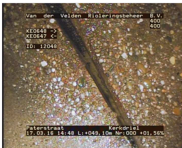
49.10 m1 Foto 031705812: Verplaatste verbinding Hoekverdraaiing
