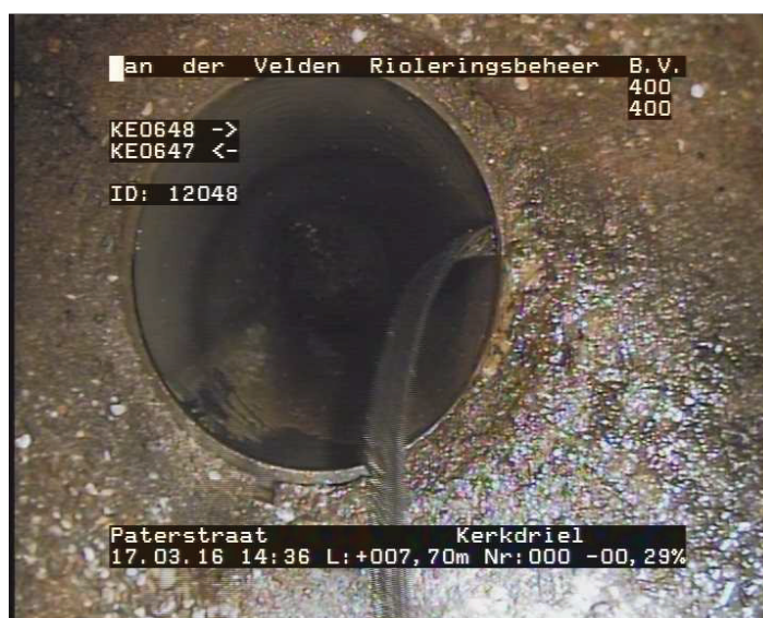
7.70 m1 Foto 031704412: Defectieve aansluiting Aansluitende buis beschadigd rubber kapot/gebroken
