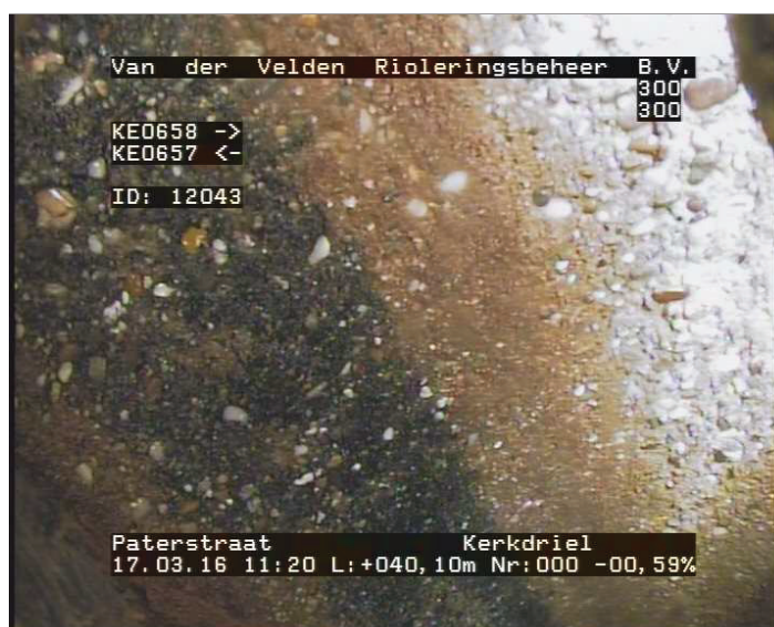
40.10 m1 Foto 031727712: Schade aan het oppervlak Afbrokkelen / zichtbare (kiesel)toeslagstof
