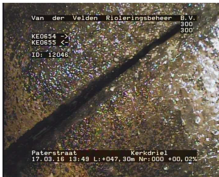
47.30 m1 Foto 031703212: Verplaatste verbinding Hoekverdraaiing
