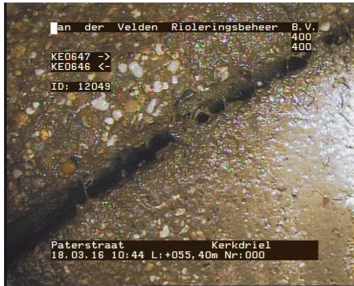
55.40 m1 Foto 031809612: Verplaatste verbinding Hoekverdraaiing
