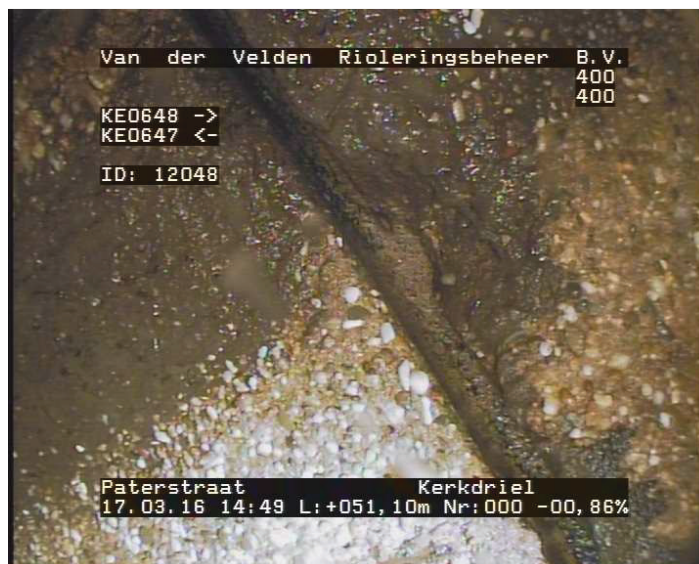
51.10 m1 Foto 031706012: Schade aan het oppervlak Afbrokkelen / zichtbare (kiezel)toeslagstof
