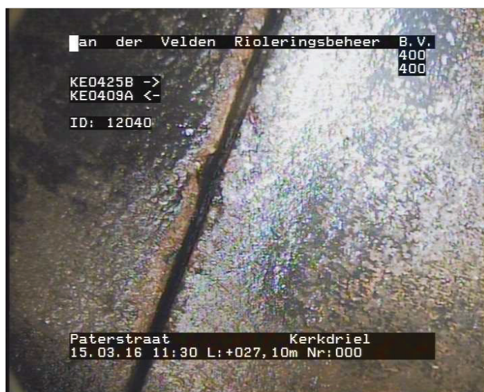
27.10 m1 Foto 031523112: Verplaatste verbinding Hoekverdraaiing
