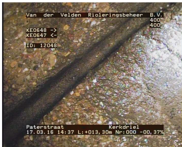
13.30 m1 Foto 031704512: Verplaatste verbinding Hoekverdraaiing
