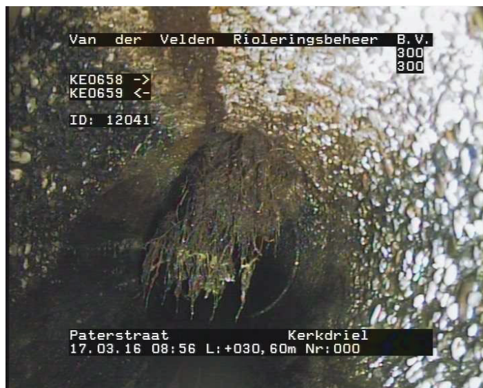
30.60 m1 Foto 031725012: Wortels Belemmering buisdoorsnede > 50%
