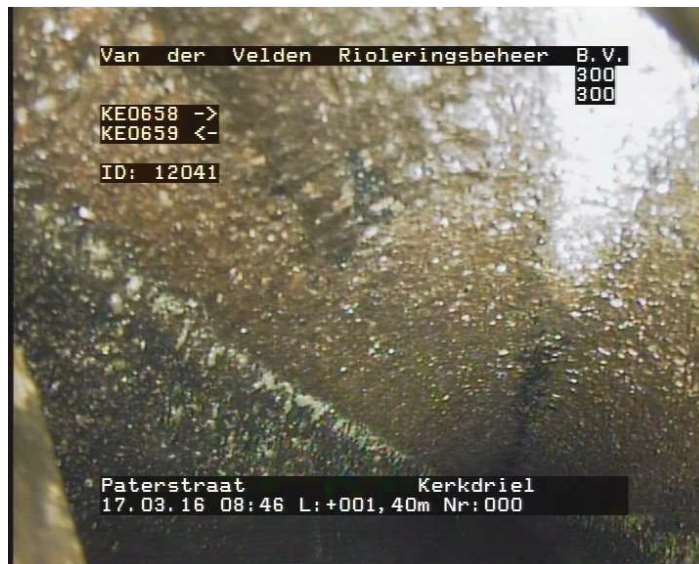
1.40 m1 Foto 031724412: Schade aan het oppervlak Toeslagstof steekt uit / wapening zichtbaar
