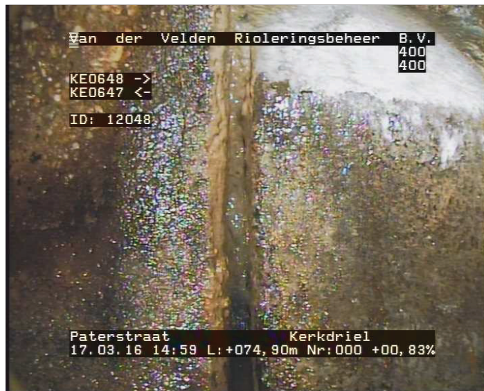
74.90 m1 Foto 031707412: Infiltratie Doorzweten
