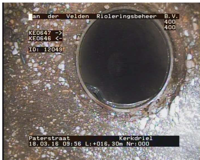
16.30 m1 Foto 031808012: Defectieve aansluiting Aansluitende buis beschadigd rubber zit niet goed!
