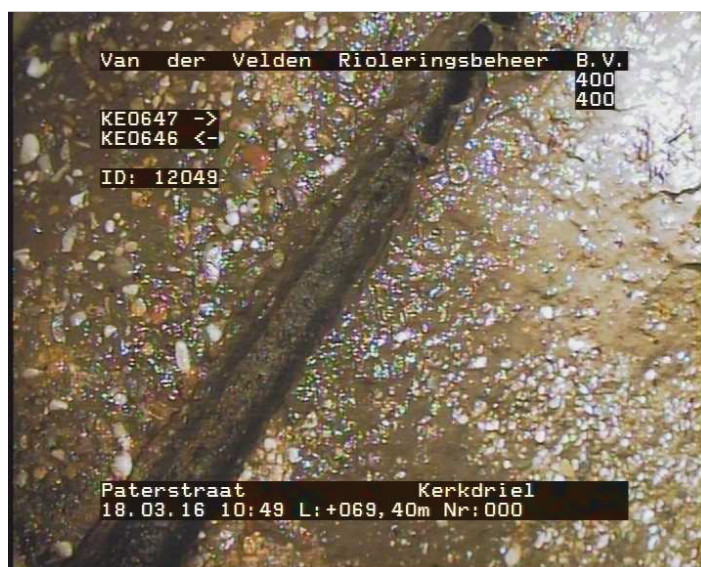
69.40 m1 Foto 031810012: Verplaatste verbinding Hoekverdraaiing
