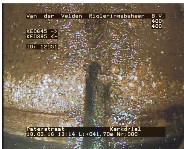
41.70 m1 Foto 031816012: Verplaatste verbinding Hoekverdraaiing
