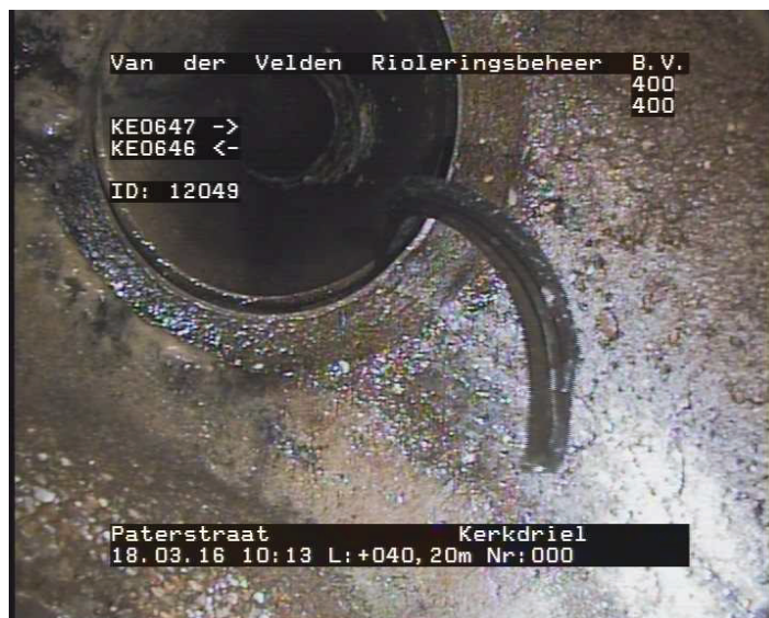
40.20 m1 Foto 031809012: Defectieve aansluiting Aansluitende buis beschadigd rubber zit niet goed!
