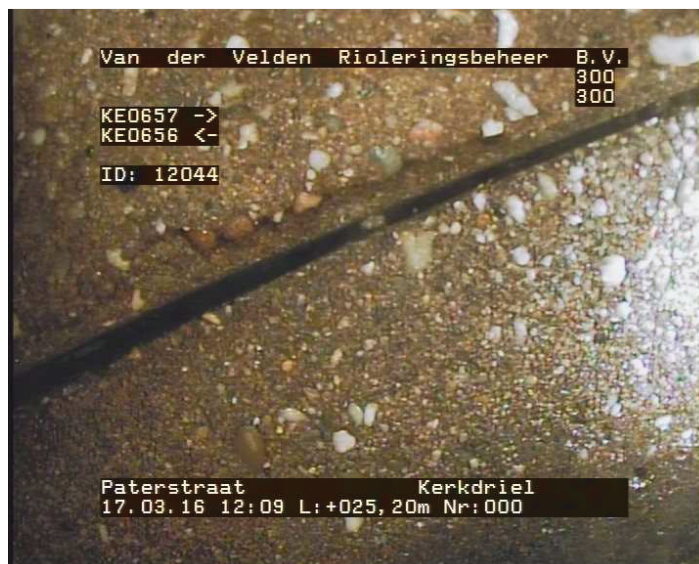
25.20 m1 Foto 031700512: Verplaatste verbinding Hoekverdraaiing
