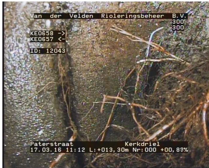
13.30 m1 Foto 031726912: Wortels Belemmering buisdoorsnede <= 10%
