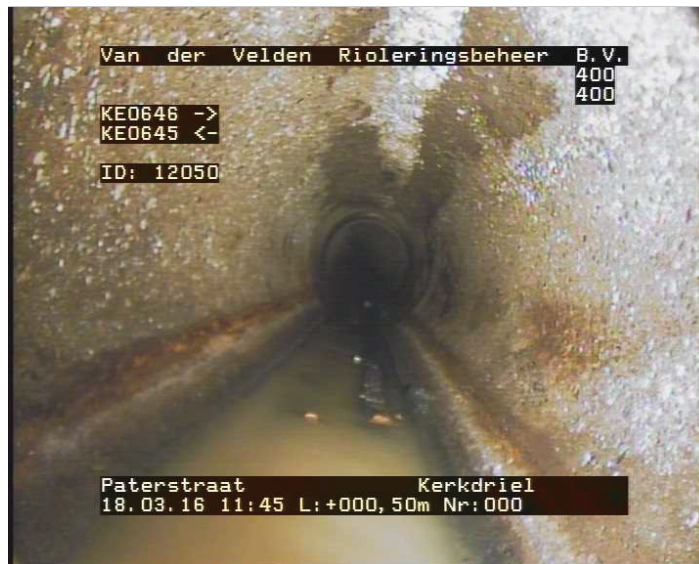
0.50 m1 Foto 031812912: Schade aan het oppervlak Afbrokkelen / zichtbare (kiezel)toeslagstof
