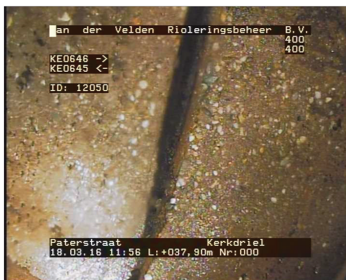
37.90 m1 Foto 031814012: Verplaatste verbinding Hoekverdraaiing
