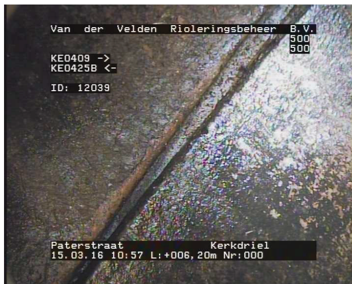
6.20 m1 Foto 031520012: Verplaatste verbinding Hoekverdraaiing
