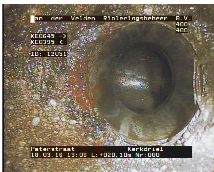
20.10 m1 Foto 031815112: Infiltratie Doorzweten
