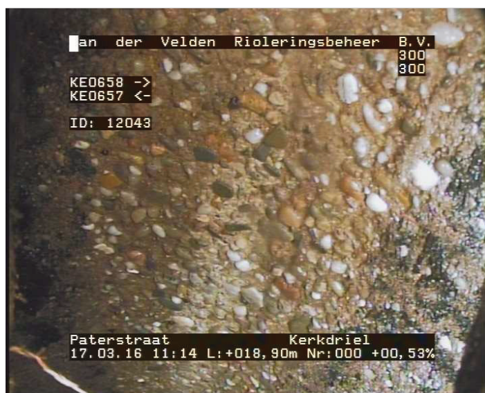
18.90 m1 Foto 031727312: Schade aan het oppervlak Toeslagstof steekt uit / wapening zichtbaar
