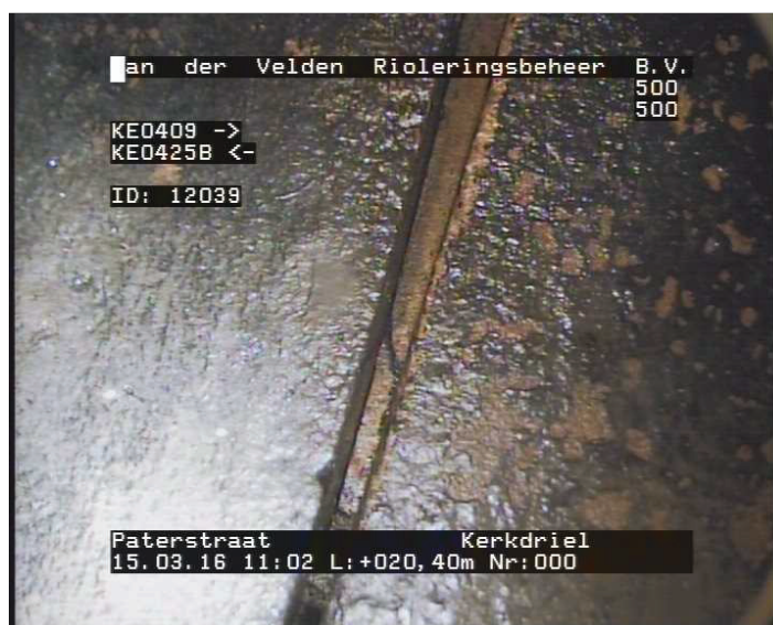
20.40 m1 Foto 031521012: Verplaatste verbinding Hoekverdraaiing
