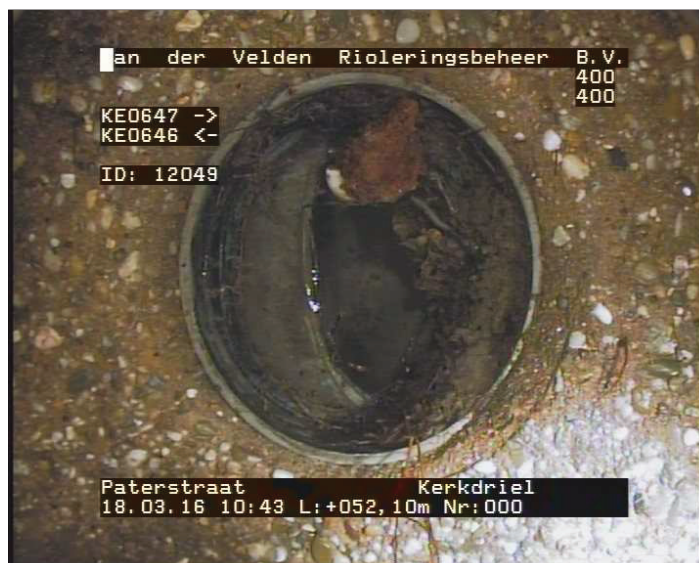
52.10 m1 Foto 031809512: Defectieve aansluiting Plaats van de aansluiting niet juist
