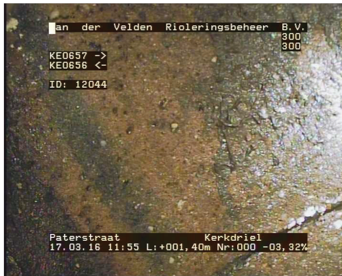
1.40 m1 Foto 031728812: Schade aan het oppervlak Afbrokkelen / zichtbare (kiezel)toeslagstof
