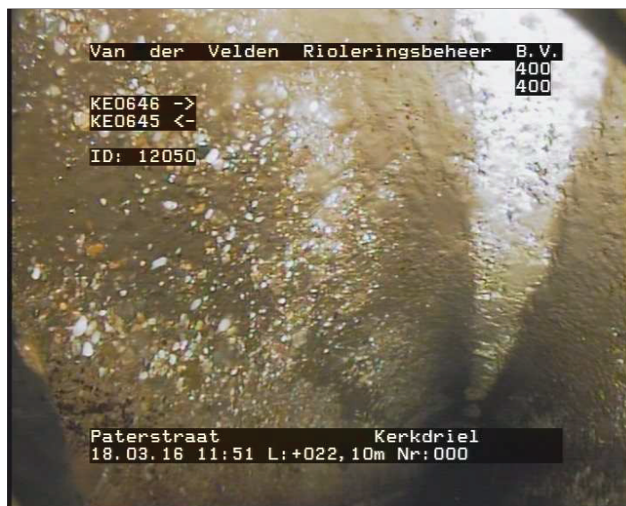
22.10 m1 Foto 031813312: Schade aan het oppervlak Toeslagstof steekt uit / wapening zichtbaar
