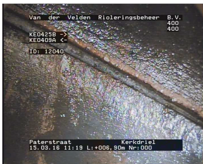
6.90 m1 Foto 031522312: Verplaatste verbinding Hoekverdraaiing
