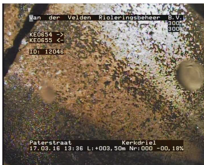
3.50 m1 Foto 031702112: Schade aan het oppervlak Afbrokkelen / zichtbare (kiezel)toeslagstof
