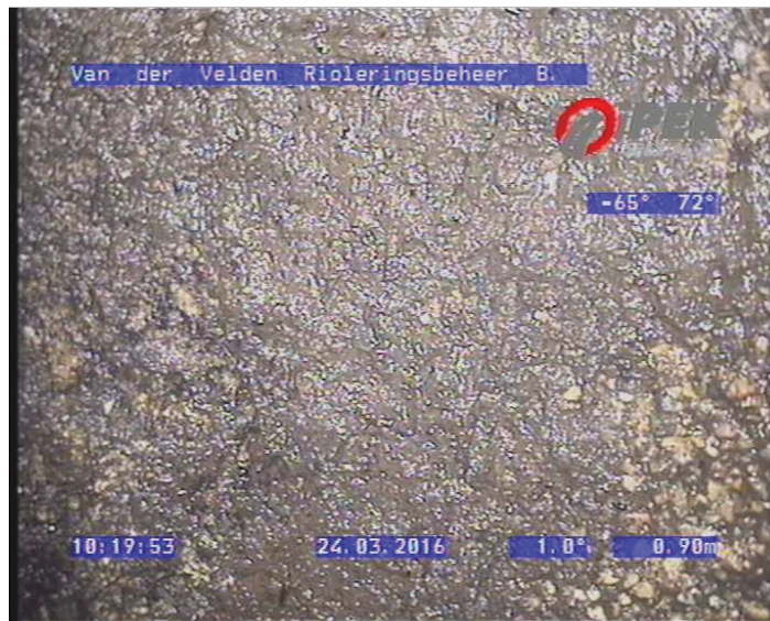
0.90 m1 Foto 032420913: Schade aan het oppervlak Afbrokkelen / zichtbare (kiezel)toeslagstof
