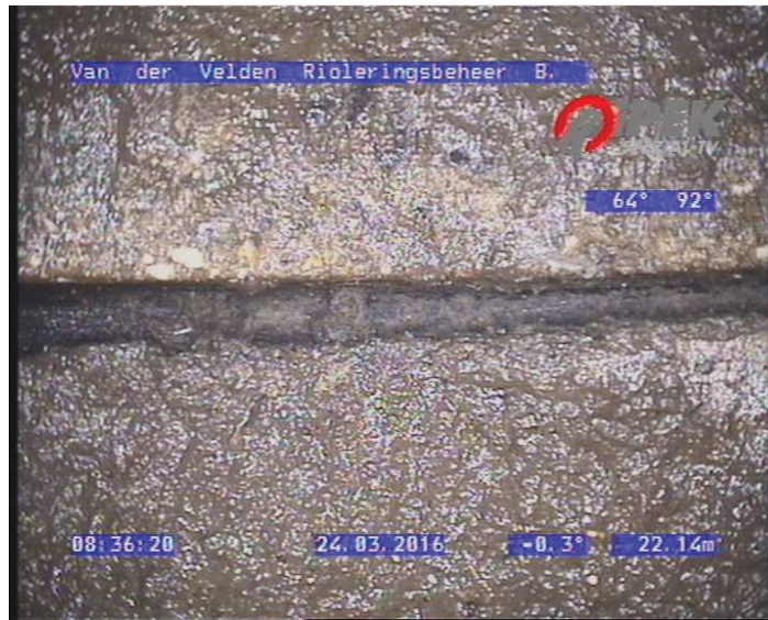
22.14 m1 Foto 032417613: Verplaatste verbinding Hoekverdraaiing
