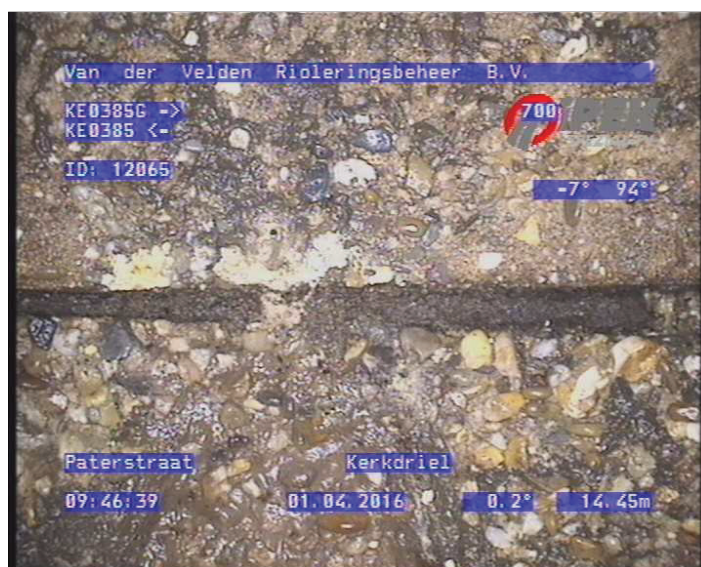
14.45 m1 Foto 040127313: Verplaatste verbinding Hoekverdraaiing
