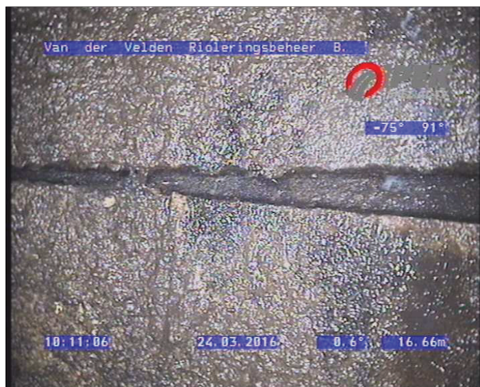
16.66 m1 Foto 032420613: Verplaatste verbinding Hoekverdraaiing
