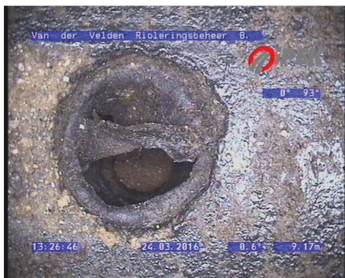
9.17 m1 Foto 032423513: Defectieve aansluiting Aansluitende buis verstopt
