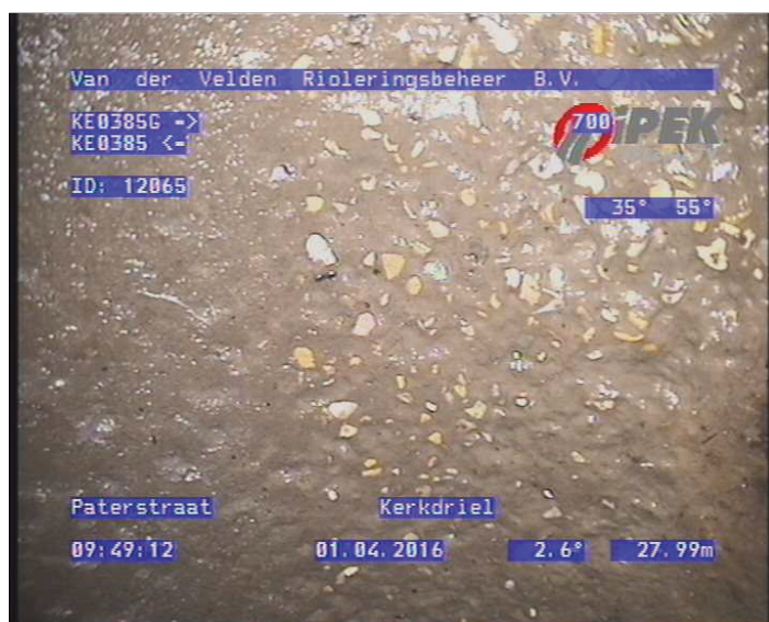
27.99 m1 Foto 040127613: Schade aan het oppervlak Toeslagstof steekt uit / wapening zichtbaar
