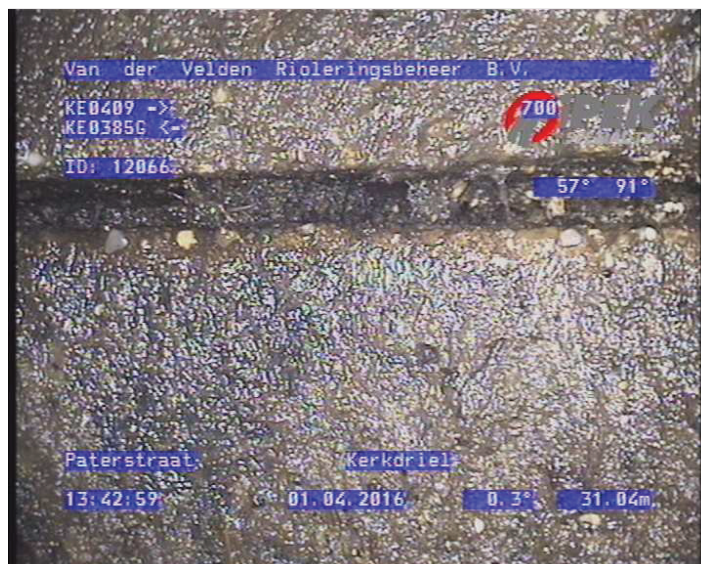
31.04 m1 Foto 040128813: Verplaatste verbinding Hoekverdraaiing
