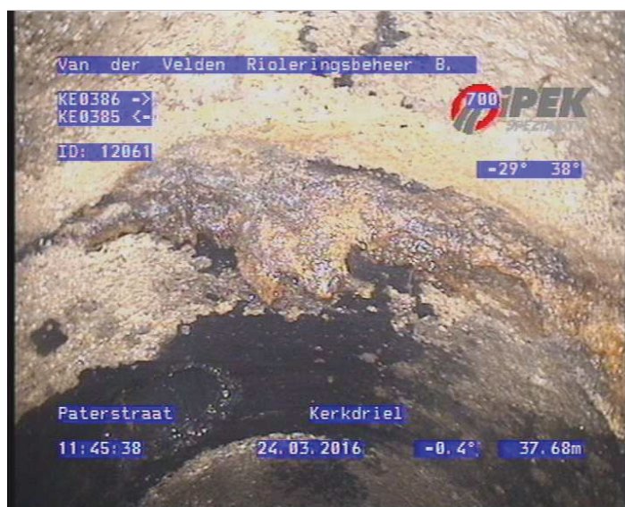
37.68 m1 Foto 032423013: Infiltratie Doorzweten
