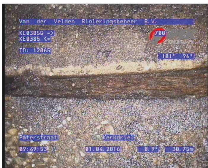
30.75 m1 Foto 040127713: Verplaatste verbinding Hoekverdraaiing
