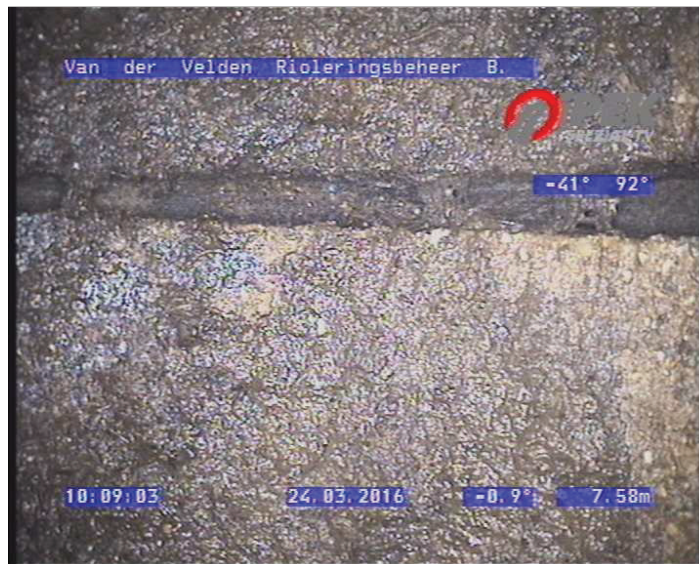
7.58 m1 Foto 032420213: Verplaatste verbinding Hoekverdraaiing
