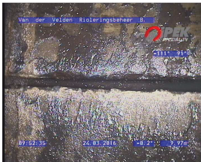
9.97 m1 Foto 032418813: Verplaatste verbinding Hoekverdraaiing
