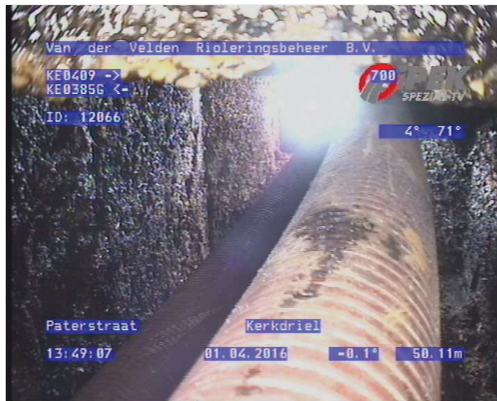
50.11 m1 Foto 040129413: Eindknoop Rioolput KE0385G
