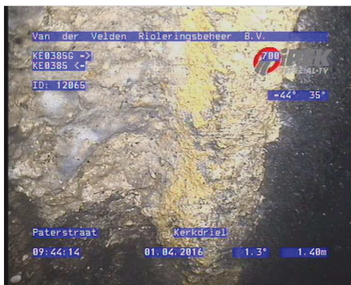
1.40 m1 Foto 040127013: Aangehechte afzettingen 5% < belemmering buisdoorsnede <= 10%
