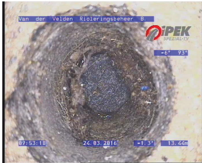
13.44 m1 Foto 032418913: Wortels Belemmering buisdoorsnede <= 10%
