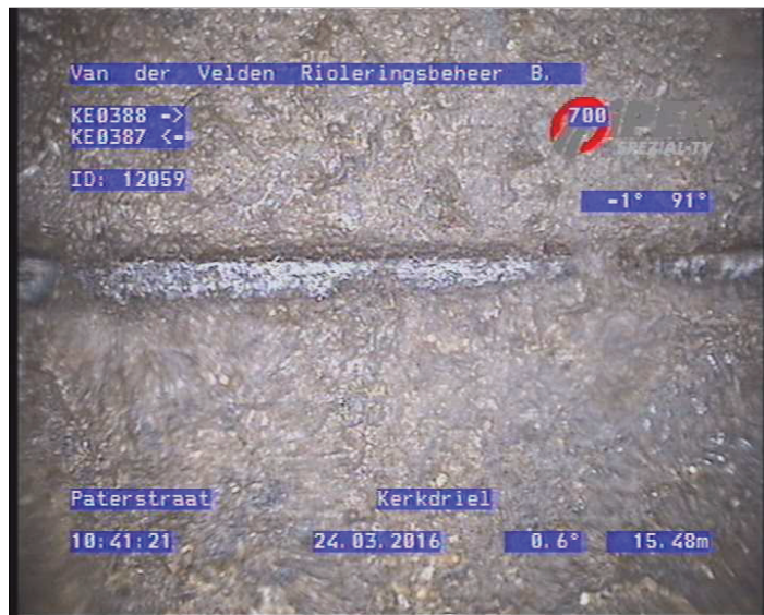
15.48 m1 Foto 032421413: Verplaatste verbinding Hoekverdraaiing
