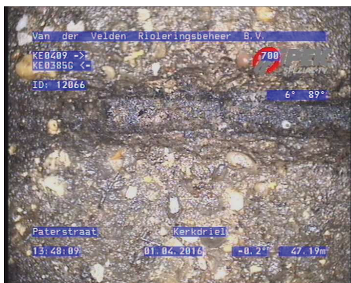
47.19 m1 Foto 040129313: Verplaatste verbinding Hoekverdraaiing
