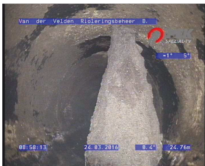
24.76 m1 Foto 032418513: Wortels 25% < belemmering buisdoorsnede <= 50%
