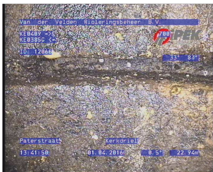
22.94 m1 Foto 040128713: Verplaatste verbinding Hoekverdraaiing
