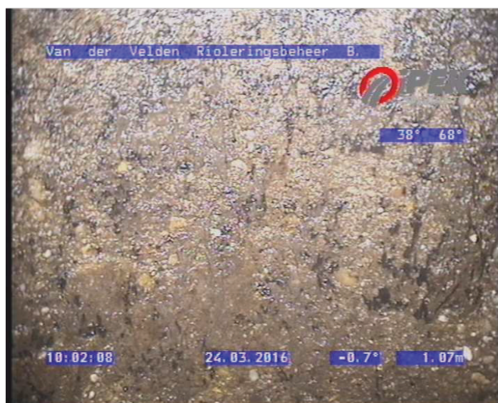
1.07 m1 Foto 032419813: Schade aan het oppervlak Afbrokkelen / zichtbare (kiesel)toeslagstof
