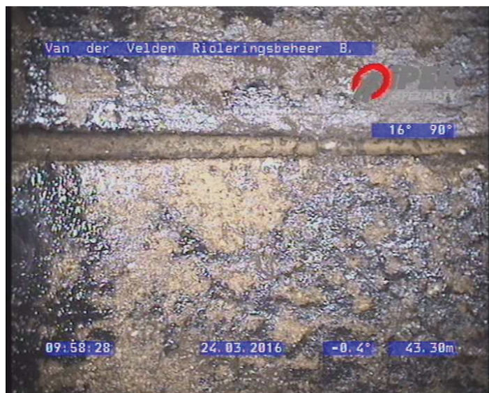
43.30 m1 Foto 032419513: Verplaatste verbinding Hoekverdraaiing
