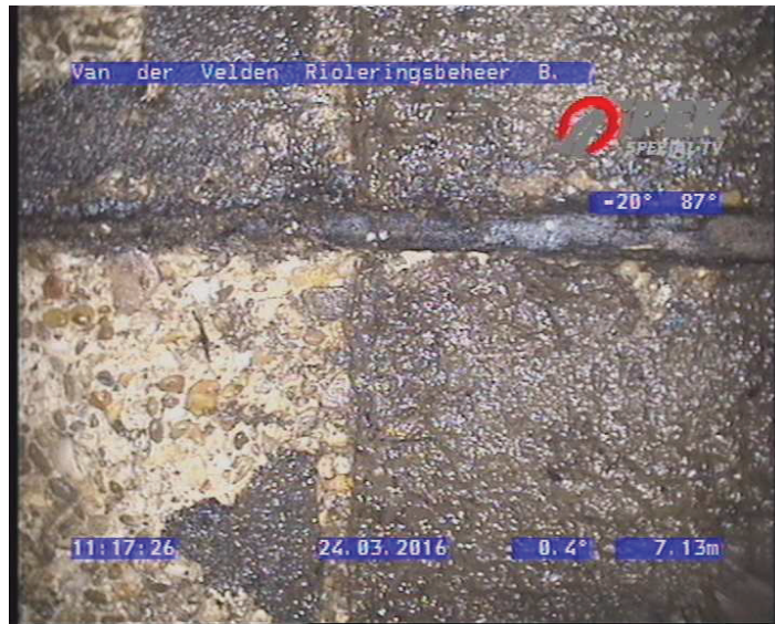
7.13 m1 Foto 032422113: Verplaatste verbinding Hoekverdraaiing
