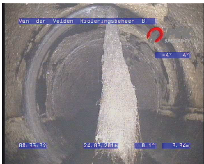
3.34 m1 Foto 032417413: Wortels 10% < belemmering buisdoorsnede <= 25%
