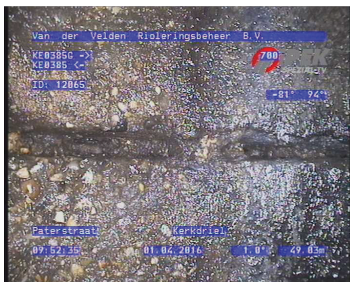
49.03 m1 Foto 040128013: Verplaatste verbinding Hoekverdraaiing
