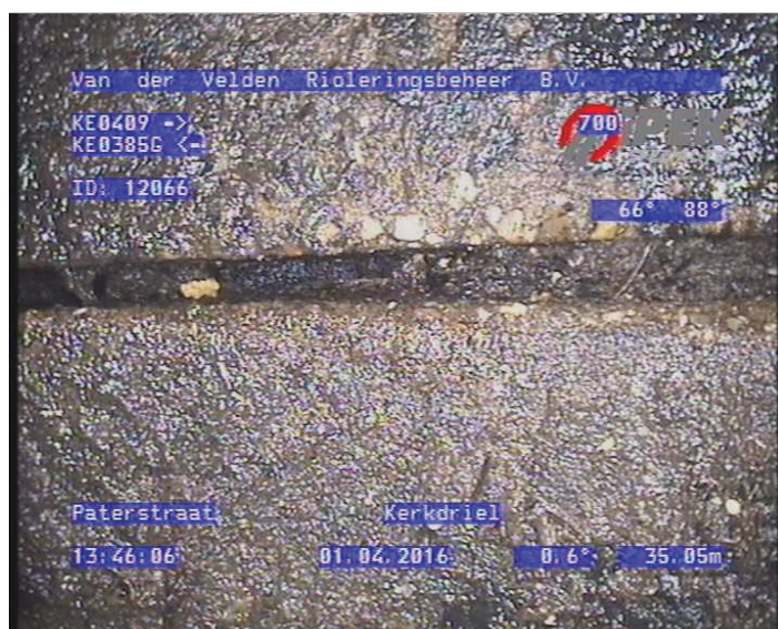
35.05 m1 Foto 040128913: Verplaatste verbinding Hoekverdraaiing
