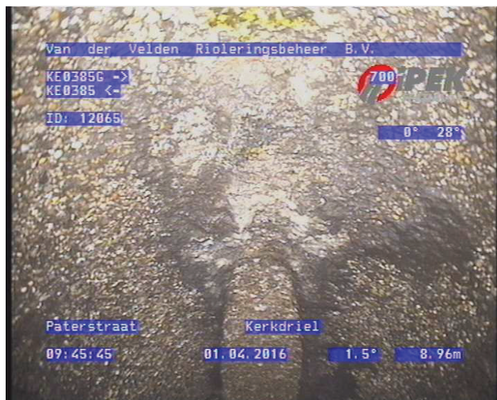
8.96 m1 Foto 040127213: Schade aan het oppervlak Toeslagstof steekt uit / wapening zichtbaar
