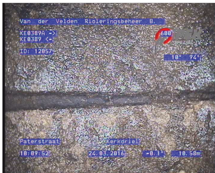
10.58 m1 Foto 032420313: Verplaatste verbinding Hoekverdraaiing
