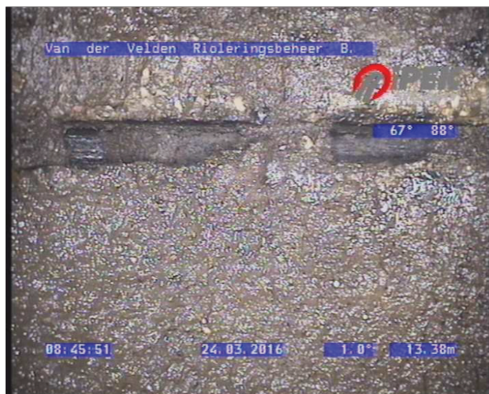
13.38 m1 Foto 032418013: Verplaatste verbinding Hoekverdraaiing
