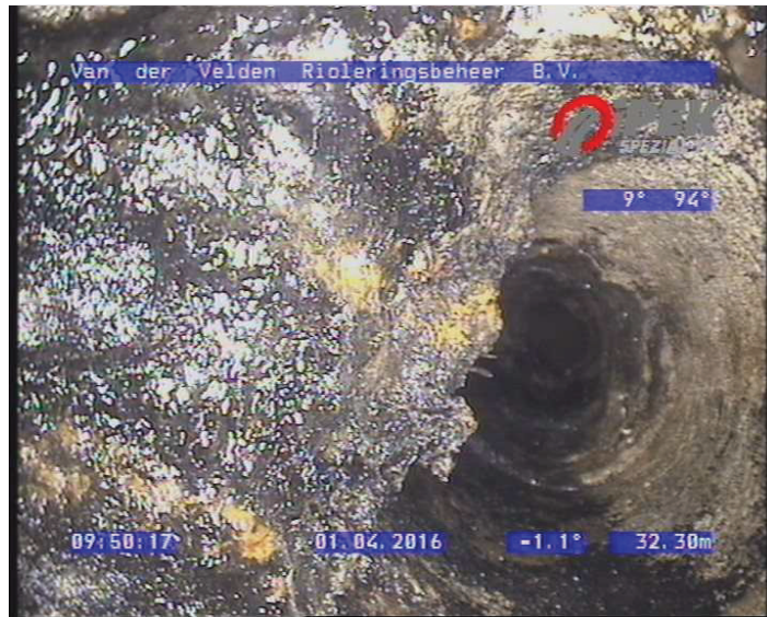
32.30 m1 Foto 040127813: Defectieve aansluiting Aansluitende buis verstopt
