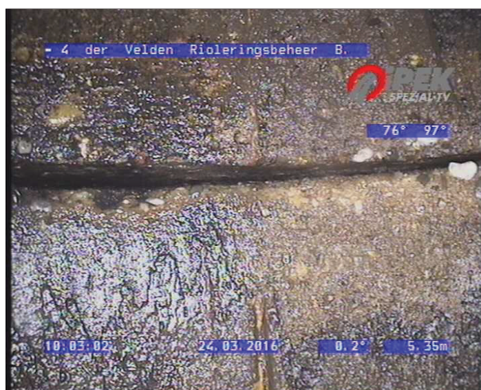
5.35 m1 Foto 032419913: Verplaatste verbinding Hoekverdraaiing
