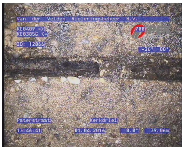
39.06 m1 Foto 040129013: Verplaatste verbinding Hoekverdraaiing
