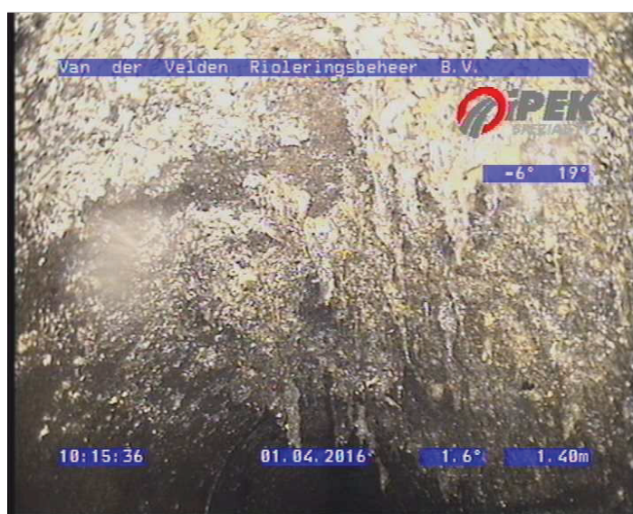
1.40 m1 Foto 040128313: Aangehechte afzettingen 5% < belemmering buisdoorsnede <= 10% Meermaals gereinigd, vervuiling blijft aan buiswand zitten!
