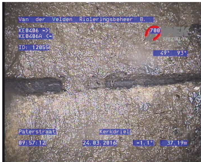
37.19 m1 Foto 032419213: Verplaatste verbinding Hoekverdraaiing
