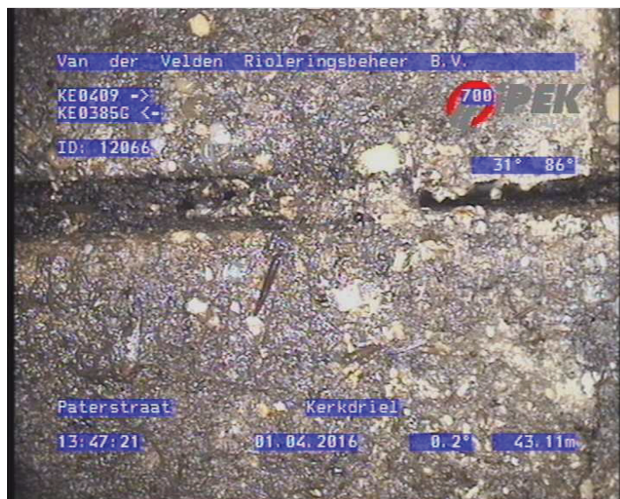
43.11 m1 Foto 040129113: Verplaatste verbinding Hoekverdraaiing
