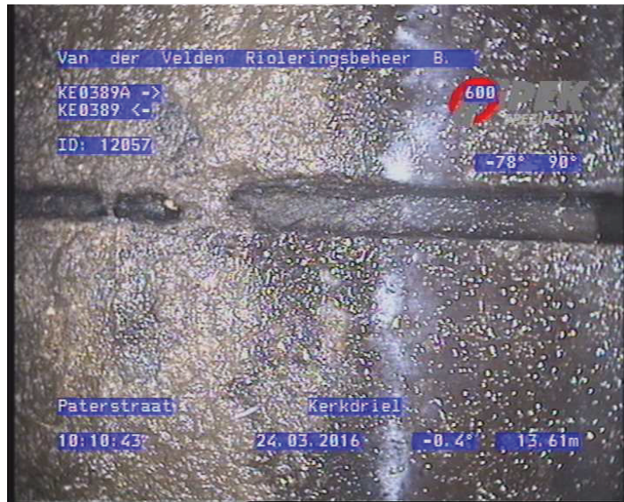
13.61 m1 Foto 032420413: Verplaatste verbinding Hoekverdraaiing
