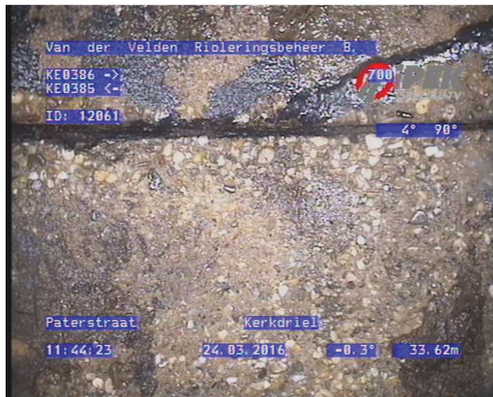
33.62 m1 Foto 032422913: Verplaatste verbinding Hoekverdraaiing
