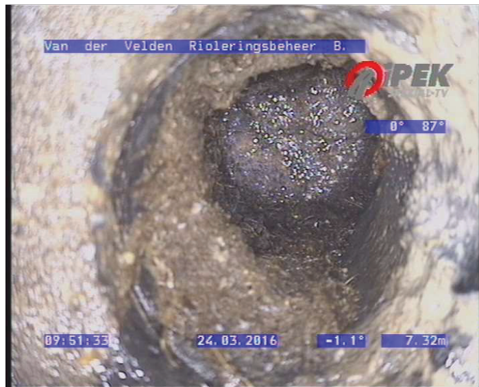
7.32 m1 Foto 032418713: Wortels Belemmering buisdoorsnede <= 10%
