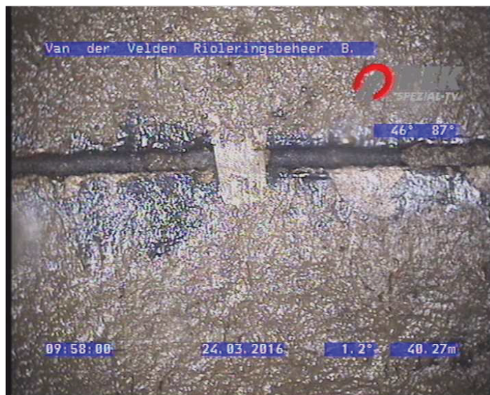
40.27 m1 Foto 032419313: Verplaatste verbinding Hoekverdraaiing
