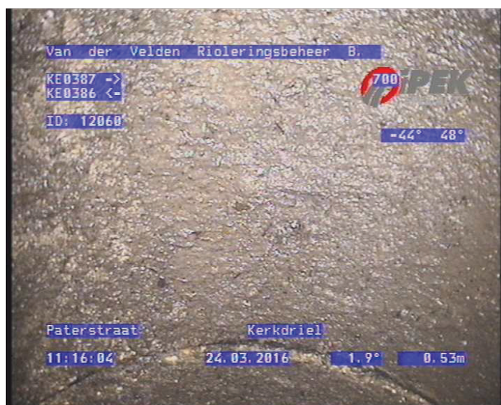
0.53 m1 Foto 032421913: Schade aan het oppervlak Afbrokkelen / zichtbare (kiezel)toeslagstof
