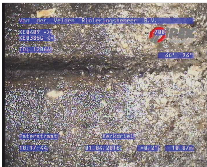
10.87 m1 Foto 040128513: Verplaatste verbinding Hoekverdraaiing
