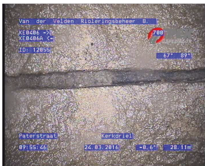
28.11 m1 Foto 032419113: Verplaatste verbinding Hoekverdraaiing
