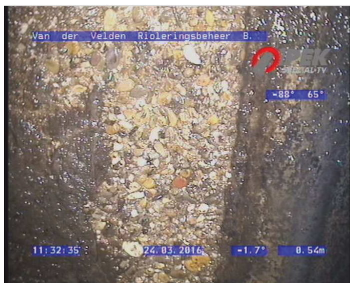
0.54 m1 Foto 032422713: Schade aan het oppervlak Toeslagstof steekt uit / wapening zichtbaar
