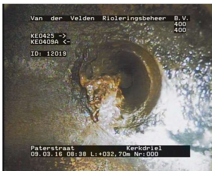
32.70 m1 Foto 030948012: Infiltratie Doorzweten
