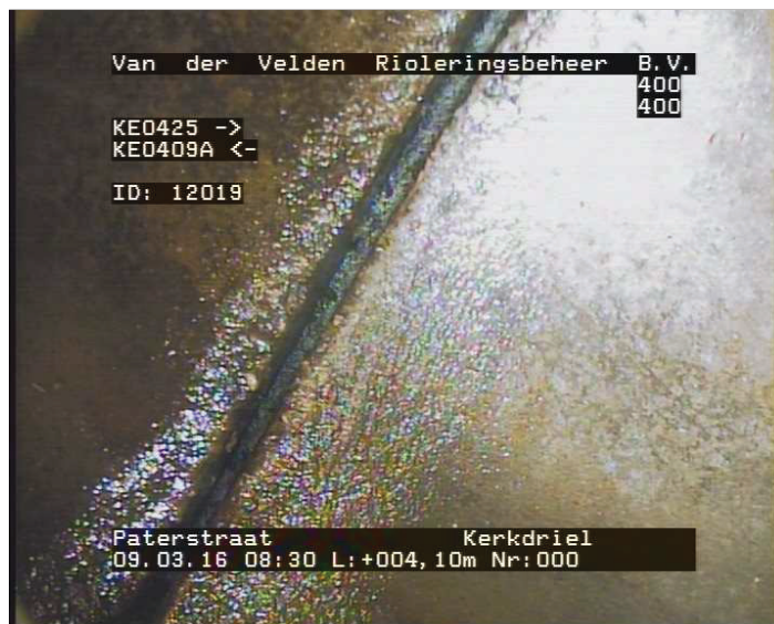
4.10 m1 Foto 030946712: Verplaatste verbinding Hoekverdraaiing
