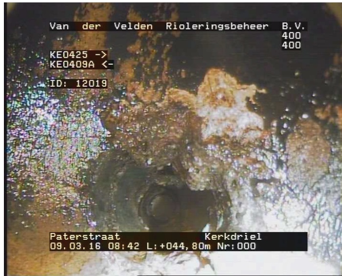
44.80 m1 Foto 030948712: Infiltratie Doorzweten
