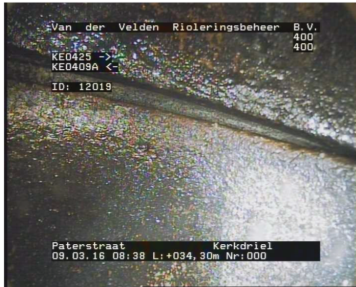
34.30 m1 Foto 030948112: Verplaatste verbinding Hoekverdraaiing
