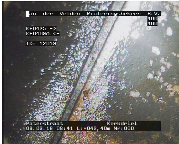
42.40 m1 Foto 030948412: Verplaatste verbinding Hoekverdraaiing
