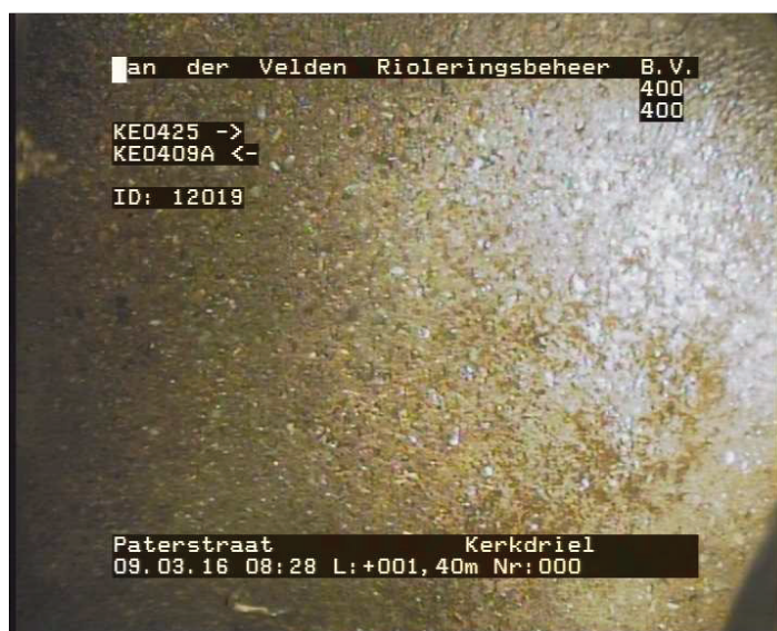
1.40 m1 Foto 030946412: Schade aan het oppervlak Afbrokkelen / zichtbare (kiezel)toeslagstof
