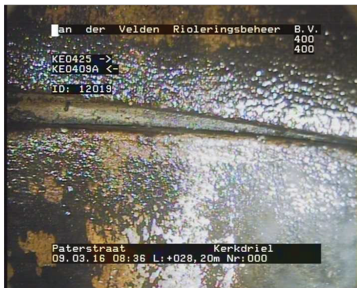
28.20 m1 Foto 030947712: Verplaatste verbinding Hoekverdraaiing
