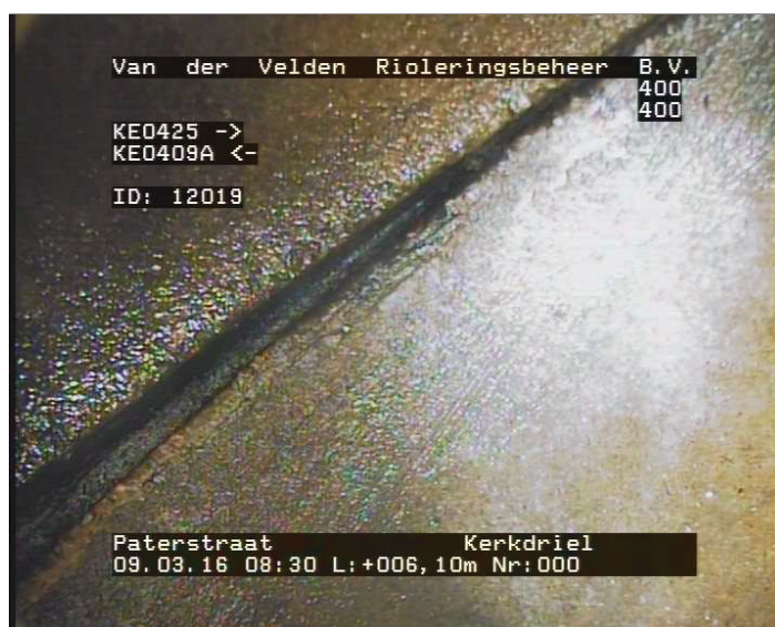
6.10 m1 Foto 030946812: Verplaatste verbinding Hoekverdraaiing
