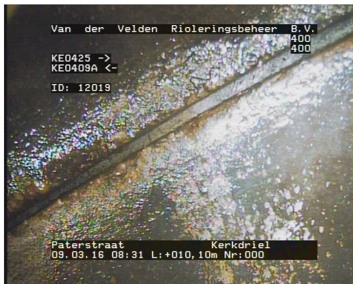
10.10 m1 Foto 030947012: Verplaatste verbinding Hoekverdraaiing
