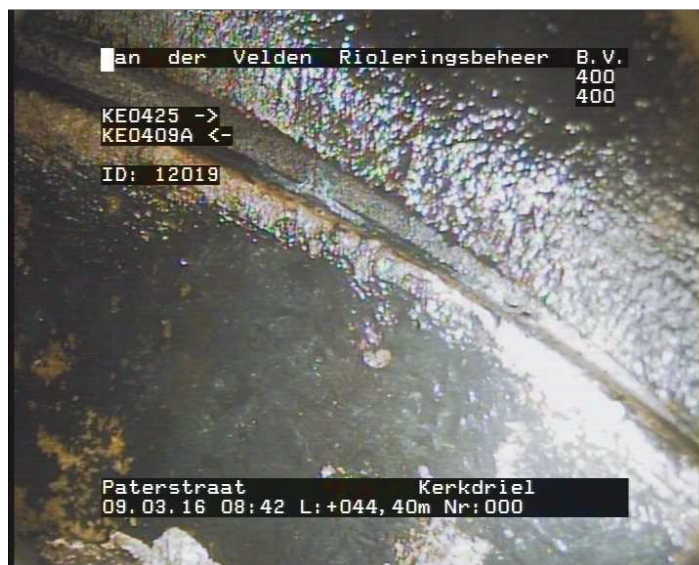
44.40 m1 Foto 030948612: Verplaatste verbinding Hoekverdraaiing
