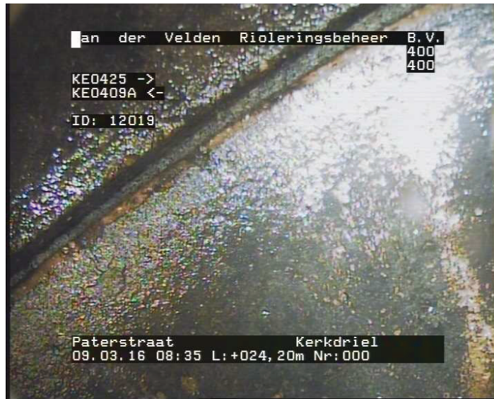
24.20 m1 Foto 030947512: Verplaatste verbinding Hoekverdraaiing
