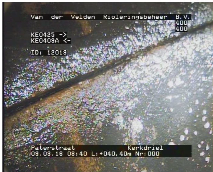
40.40 m1 Foto 030948212: Verplaatste verbinding Hoekverdraaiing
