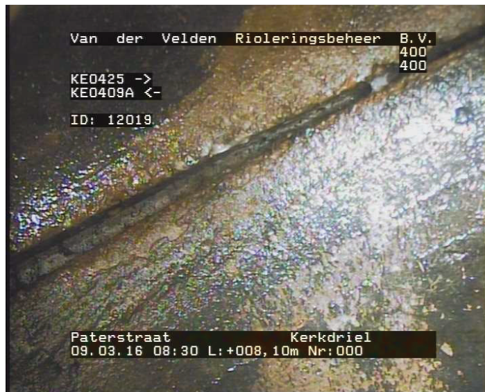
8.10 m1 Foto 030946912: Verplaatste verbinding Hoekverdraaiing
