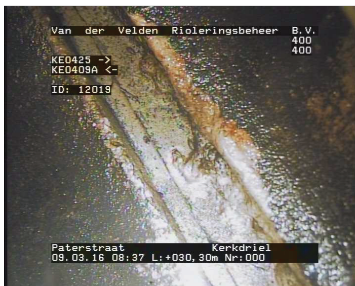
30.30 m1 Foto 030947912: Infiltratie Doorzweten
