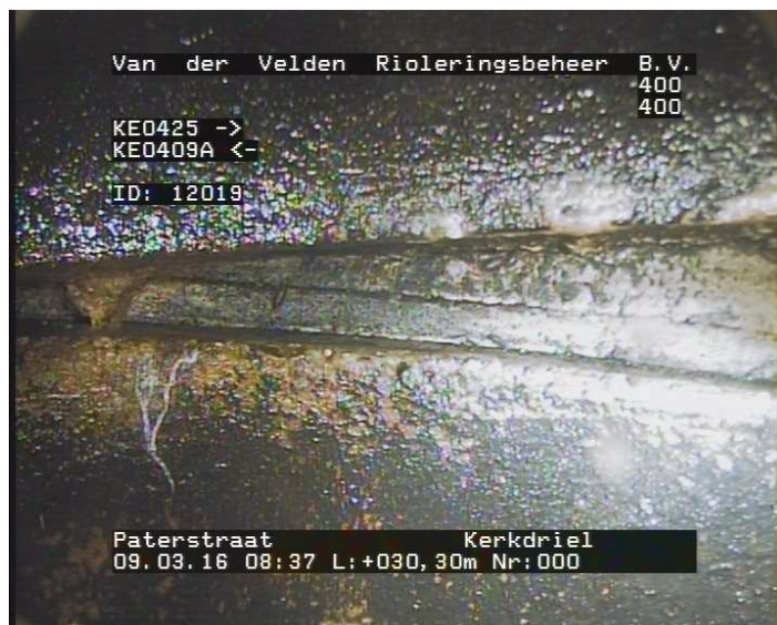
30.30 m1 Foto 030947812: Verplaatste verbinding Hoekverdraaiing
