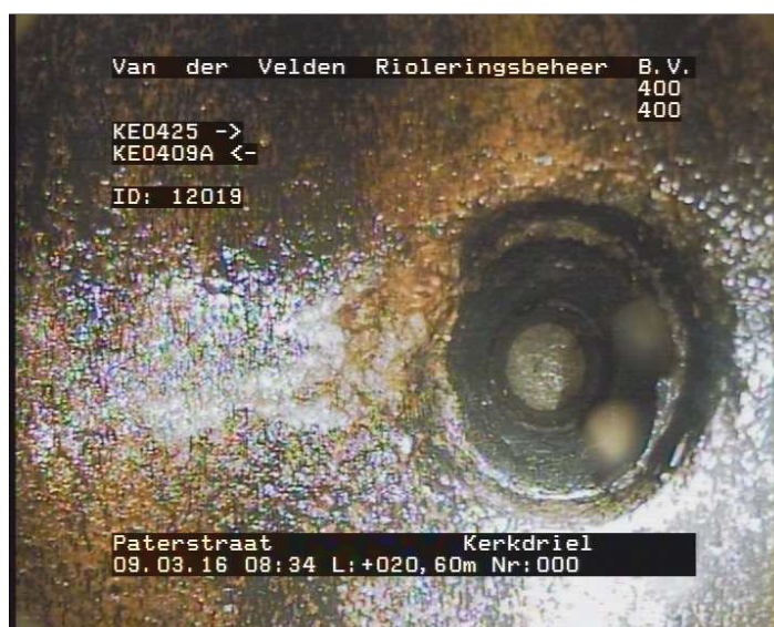
20.60 m1 Foto 030947412: Infiltratie Doorzweten
