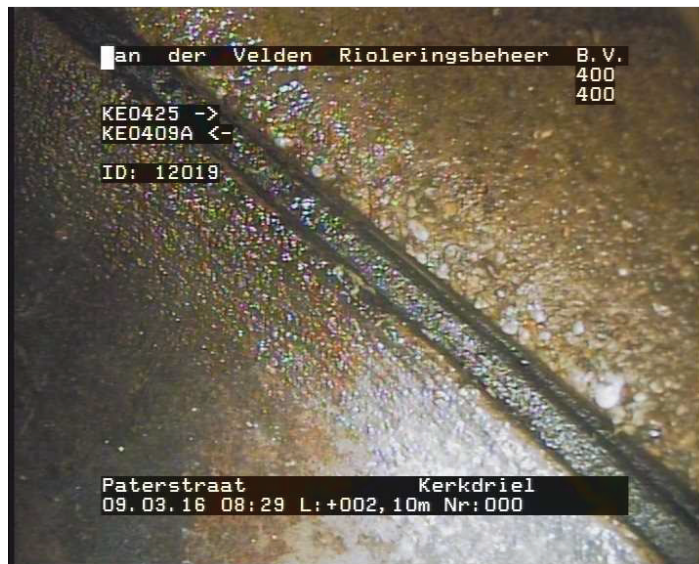
2.10 m1 Foto 030946612: Infiltratie Doorzweten
