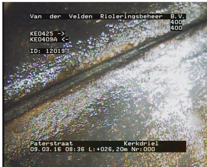
26.20 m1 Foto 030947612: Verplaatste verbinding Hoekverdraaiing
