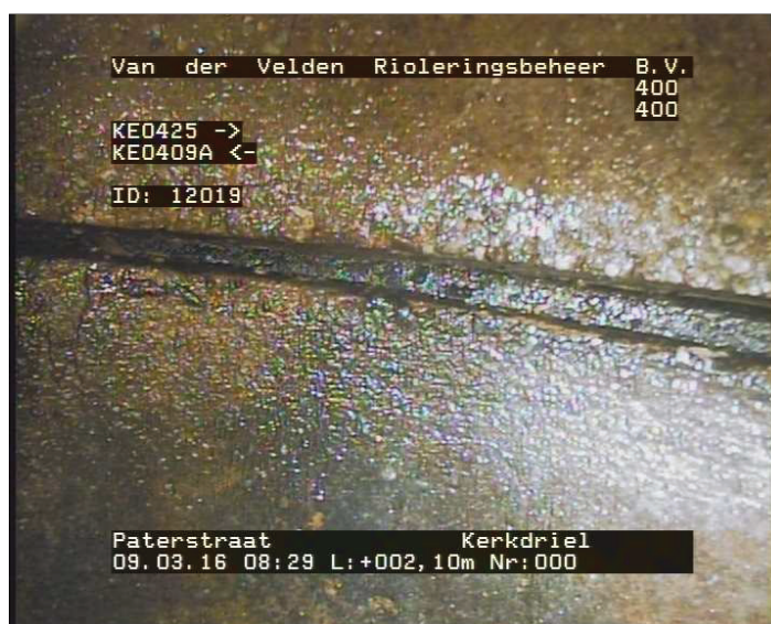
2.10 m1 Foto 030946512: Verplaatste verbinding Hoekverdraaiing
