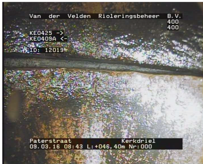
46.40 m1 Foto 030948812: Verplaatste verbinding Hoekverdraaiing
