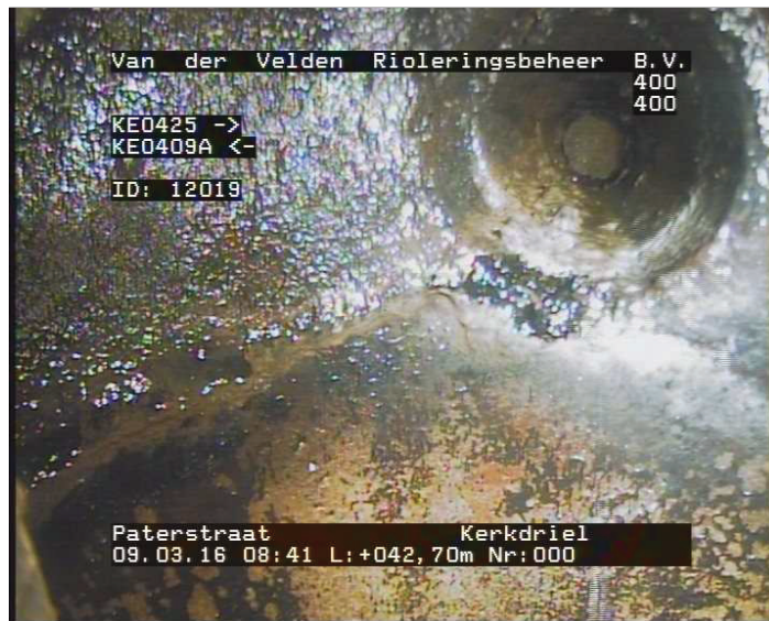
42.70 m1 Foto 030948512: Infiltratie Doorzweten
