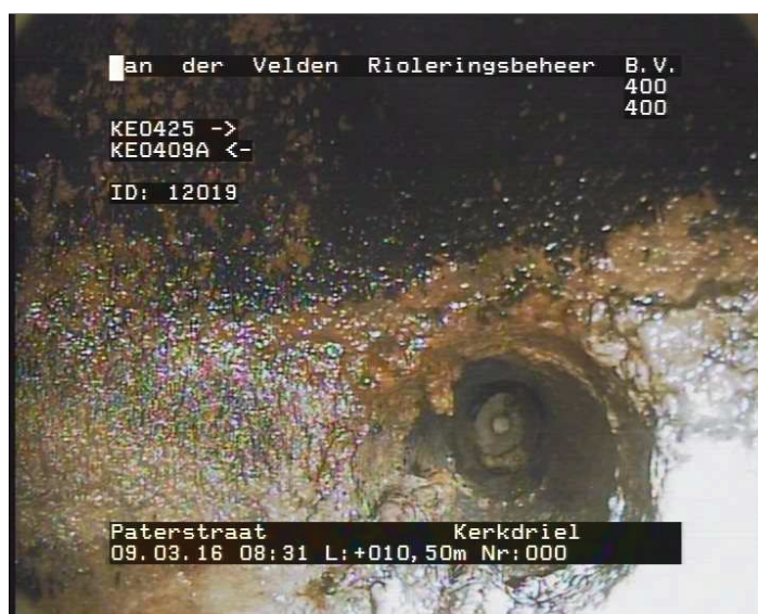
10.50 m1 Foto 030947112: Infiltratie Doorzweten
